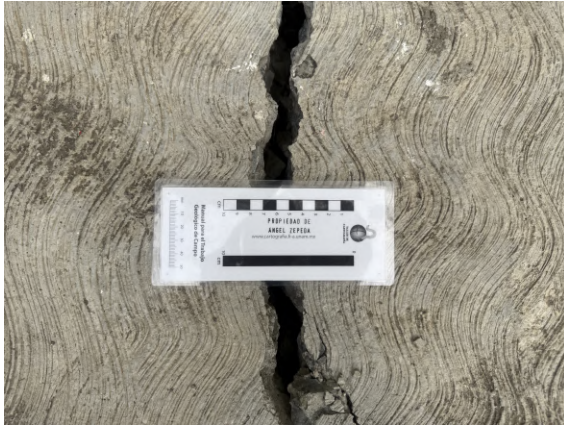
(a) Grieta a nivel de suelo en uno de los inmuebles.
