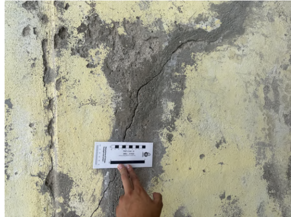
(b) Grieta a 45° en pared, previamente resanada.
