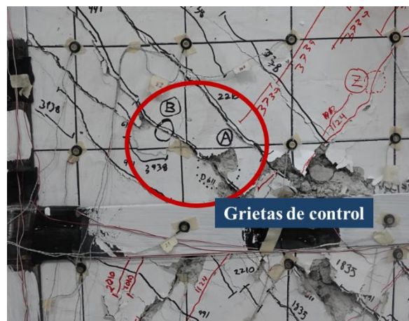
Figura 3.13 Grieta de control B (ciclo 12, distorsión ++3%).
