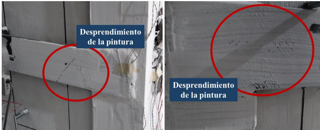
Figura 3.12 Desprendimiento de la pintura de la solera central de la cara Este (ciclo 11, distorsión -3%).
