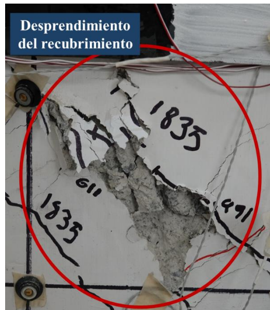
Figura 3.9 Desprendimiento del recubrimiento de la cara Norte (ciclo 8, distorsión -2%).
