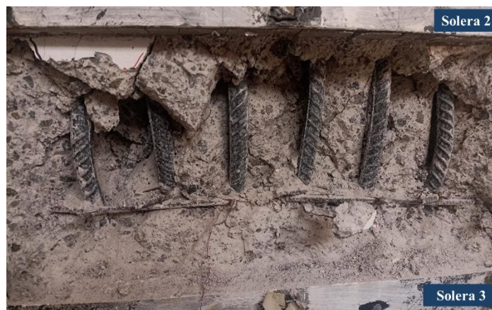
Figura 3.31 Barras longitudinales pandeadas de la cara Norte.
