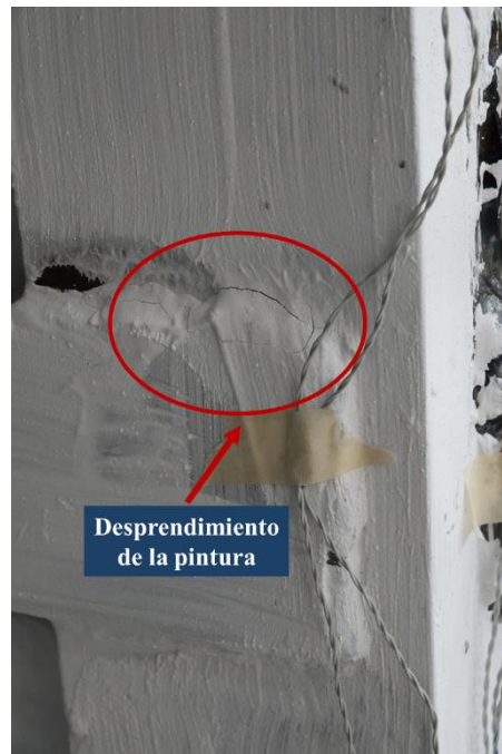
Figura 3.7 Desprendimiento de la pintura de cal en la cara Este (ciclo 6, distorsión ++1.5%).
