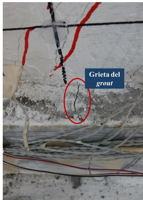
Figura 3.21 Agrietamiento del grout en la cara Norte (ciclo 9, distorsión -2.5%).
