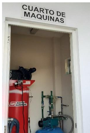
Imagen 30. Cuarto de máquinas identificado. Tomada en sitio.
