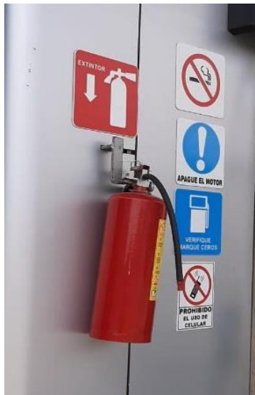
Imagen 49. Señalética de extintor en zona de dispensario. Tomada en sitio.
