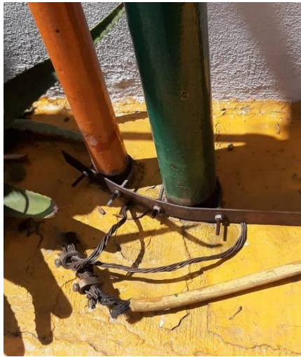
Imagen 40. Tierra física en líneas de venteo aterrizada. Tomada en sitio.
