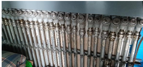
Imagen 29. Conexiones eléctricas identificadas. Tomada en sitio.
