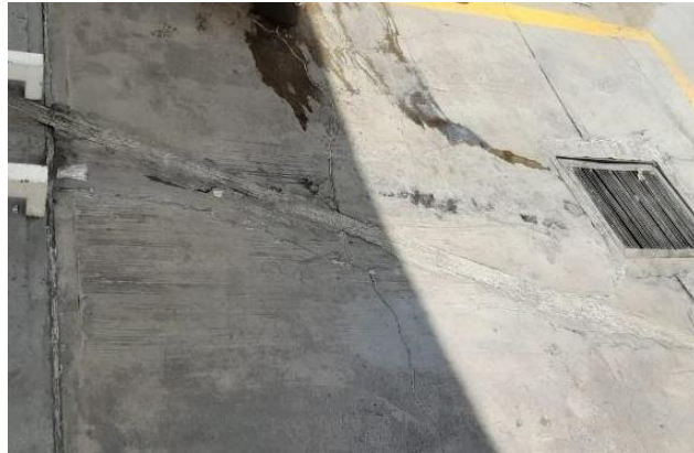
Imagen 23. Pavimento en zona de descarga de combustible con fracturas. Tomada en sitio.
