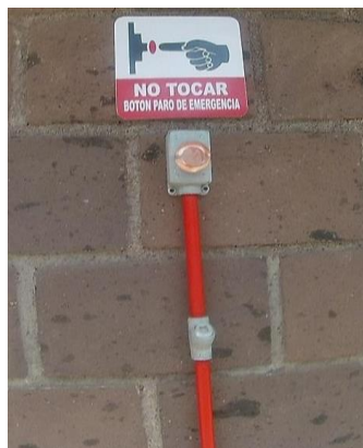
Imagen 52. Paro de emergencia en fachada. Tomada en sitio.
