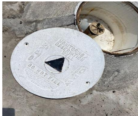
Imagen 19. Tapa metálica del pozo de observación. Tomada en sitio.
