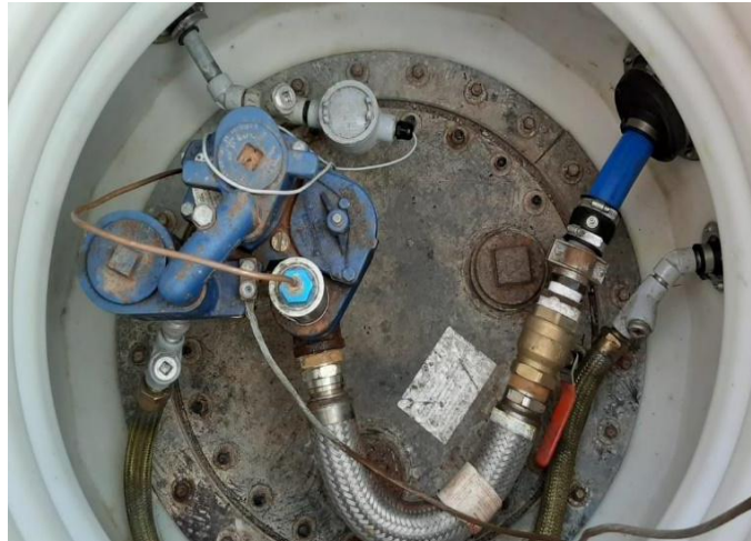
Imagen 4. Registro de motobomba. Tomada en sitio.
