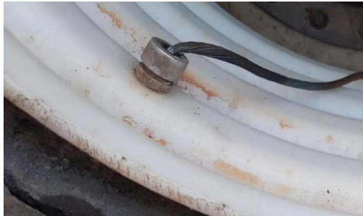
Imagen 6. Glándula de tierra física en contenedor motobomba. Tomada en sitio.
