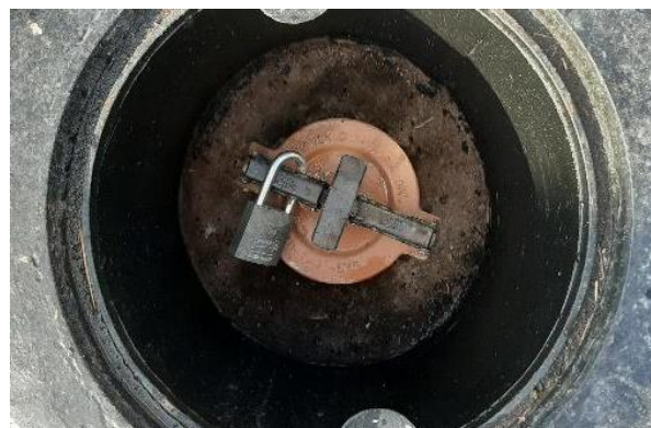
Imagen 16. Registro de recuperación de vapores de tanque diésel. Tomada en sitio.
