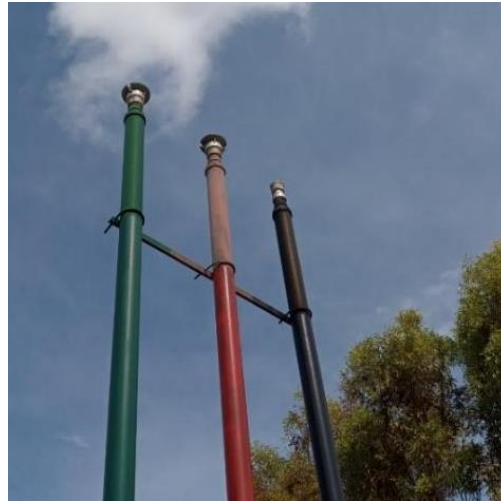
Imagen 42. Válvula de venteo y arrestador de flama. Tomada en sitio.
