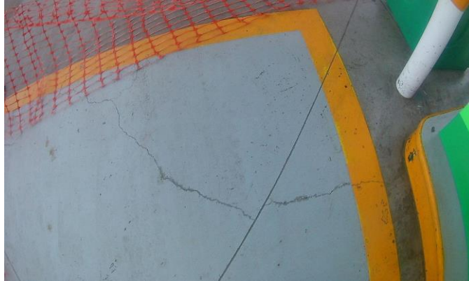
Imagen 58. Marcaje horizontal con fisuras. Tomada en sitio.
