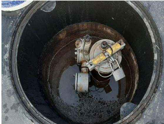
Imagen 9. Registro de telemetría de tanque de diésel. Tomadas en sitio.
