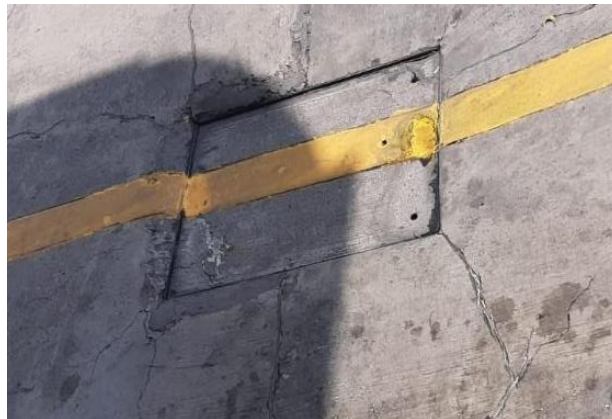
Imagen 22. Pavimento en zona de abastecimiento de combustible con fisura. Tomada en sitio.
