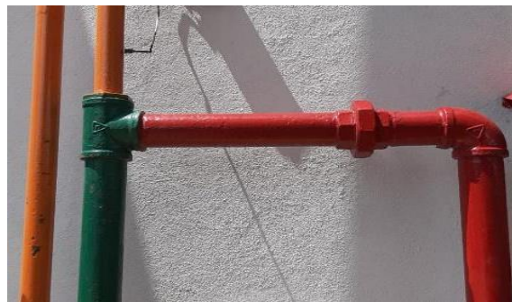
Imagen 41. Conexión de tubería para válvula de venteo. Tomada en sitio.
