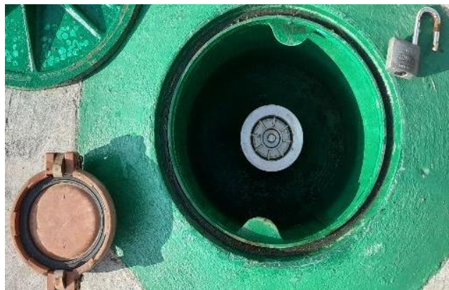
Imagen 15. Registro de recuperación de vapores de tanque regular. Tomada en sitio.
