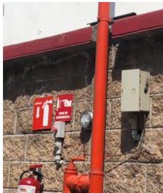
Imagen 51. Señalética de paro de emergencia. Tomada en sitio.
