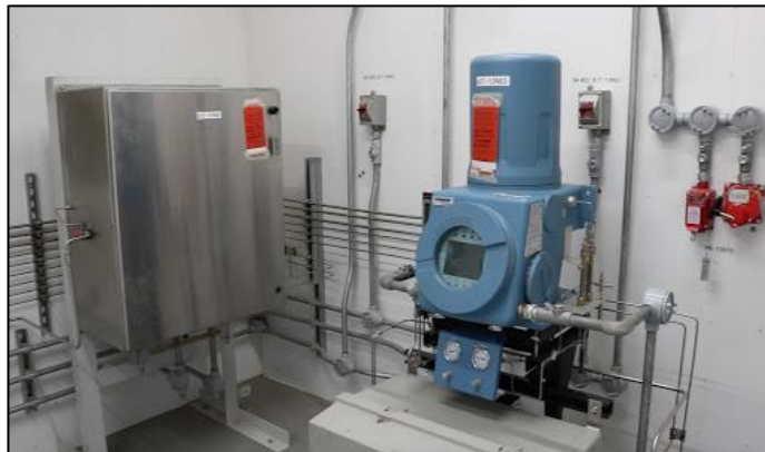
Figura 5.-Cromatógrafos de gases, Analizadores de calidad de gas COIMSUR 2020
