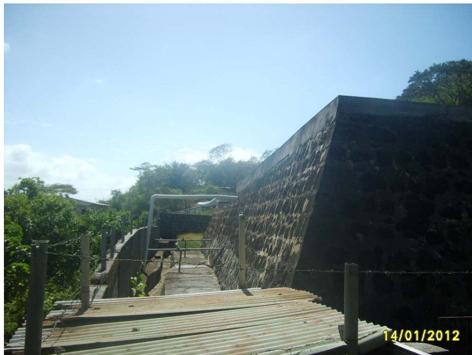
Figura 11 Área de captación de agua de lluvia ubicada al lado del hospital con vista de la zona de almacenaje y conexiones.
