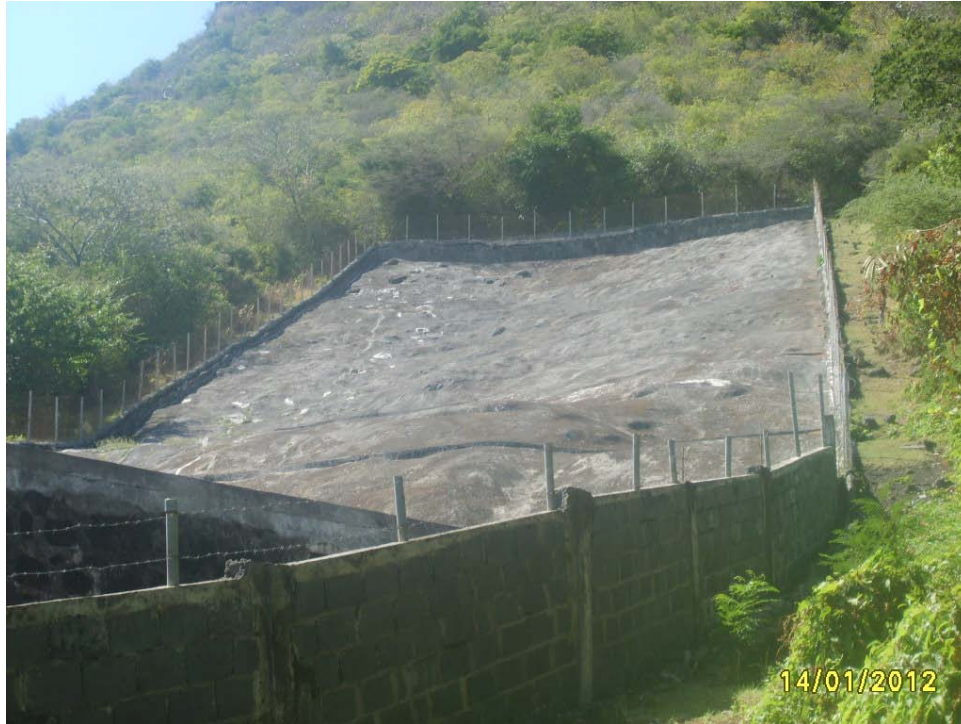
Figura 10 Área de captación de agua de lluvia ubicado al lado del hospital
