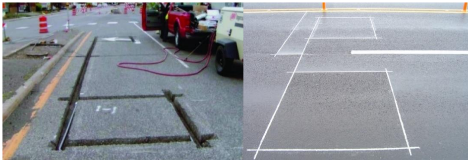
Figura 5 Instalación y Operación del DBI
