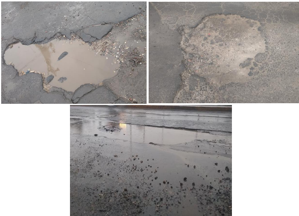
Figura 2.5.3. Baches generados por desprendimientos de la carpeta asfáltica
