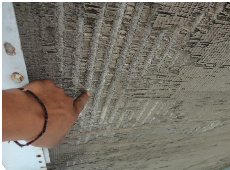
Foto 3.14. Presencia excesiva de lodo y aletas rotas por corrosión U.C-05.
