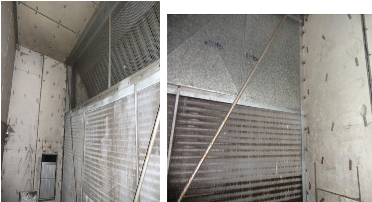
Foto 3.6. Parte interna de UMA-05 y Serpentines sucios y lodo.
