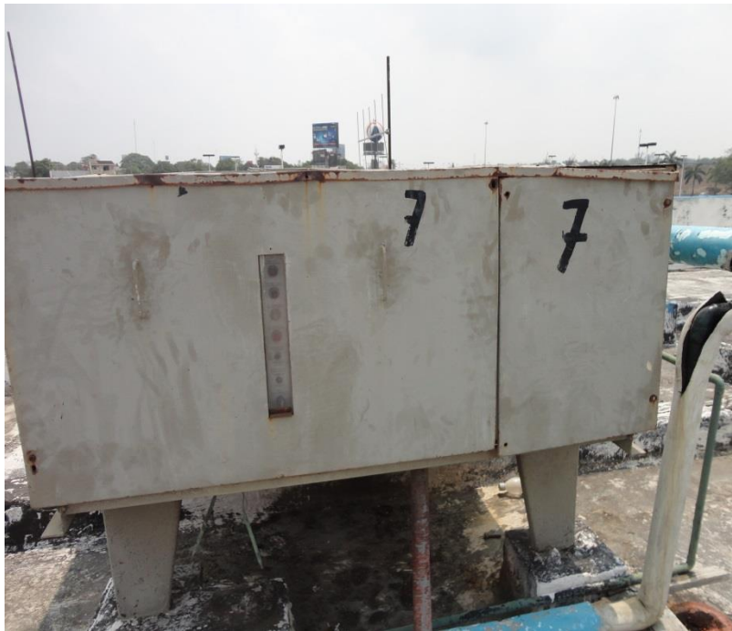
Foto 3.16. Gabinete dañado y pintura en malas condiciones U.C-07.
