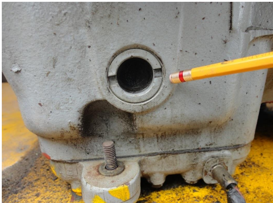
Foto 3.24. Revisión de nivel de aceite U.C-10 (Fuente Levantamiento Aeropuerto Tampico)
