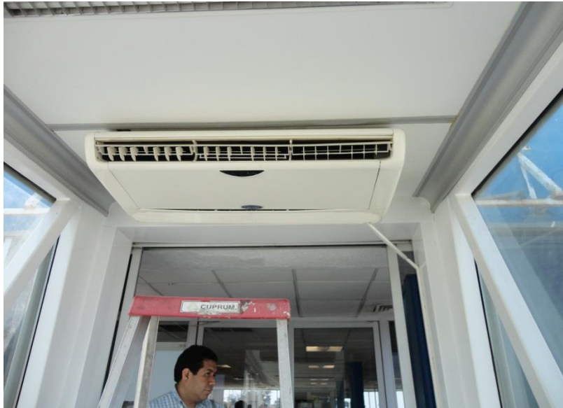
Foto 3.30. Unidad Evaporadora en mal estado M.S-04 (Fuente Levantamiento Aeropuerto Tampico)
