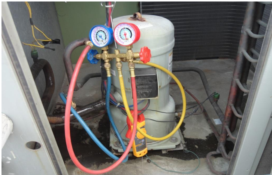
Foto 3.10. Medición de presiones alta y baja para detección de fugas de gas. (Fuente Levantamiento Aeropuerto Tampico)
