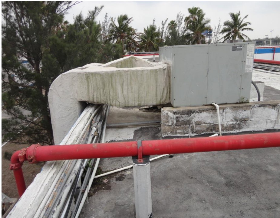
Foto 3.26. Aislamiento térmico de ductos y tuberías dañado U.P-02 (Fuente Levantamiento Aeropuerto Tampico)
