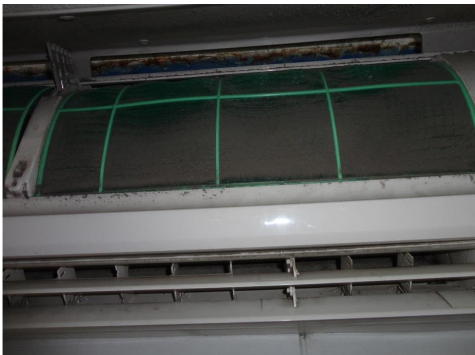
Foto 3.27. Unidad Evaporadora en buen estado M.S.-01 (Fuente Levantamiento Aeropuerto Tampico)
