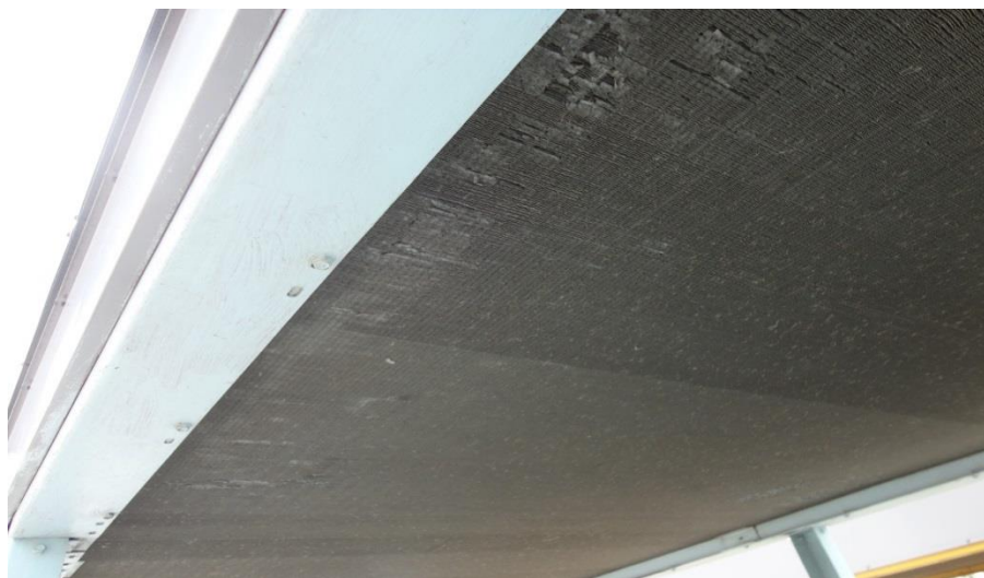
Foto 3.13. Presencia de lodo y suciedad en el serpentín de U.C-04. (Fuente Levantamiento Aeropuerto Tampico)
