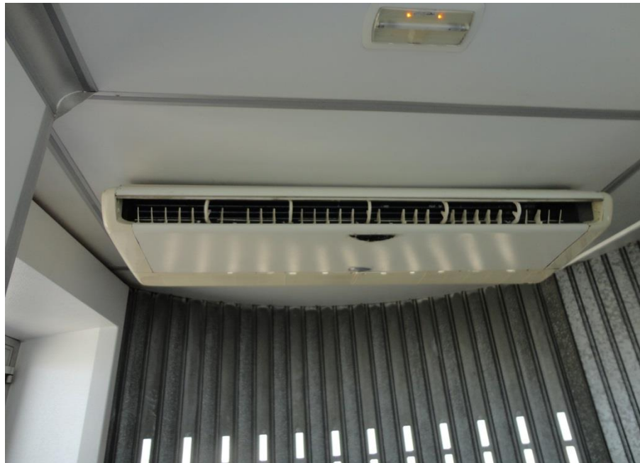
Foto 3.29. Unidad Evaporadora en mal estado M.S-03 (Fuente Levantamiento Aeropuerto Tampico)
