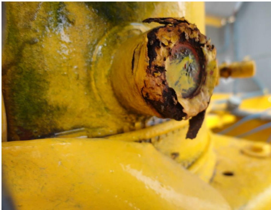
Foto 3.19. Mirilla para revisar nivel de aceite con corrosión. (Fuente Levantamiento Aeropuerto Tampico)
