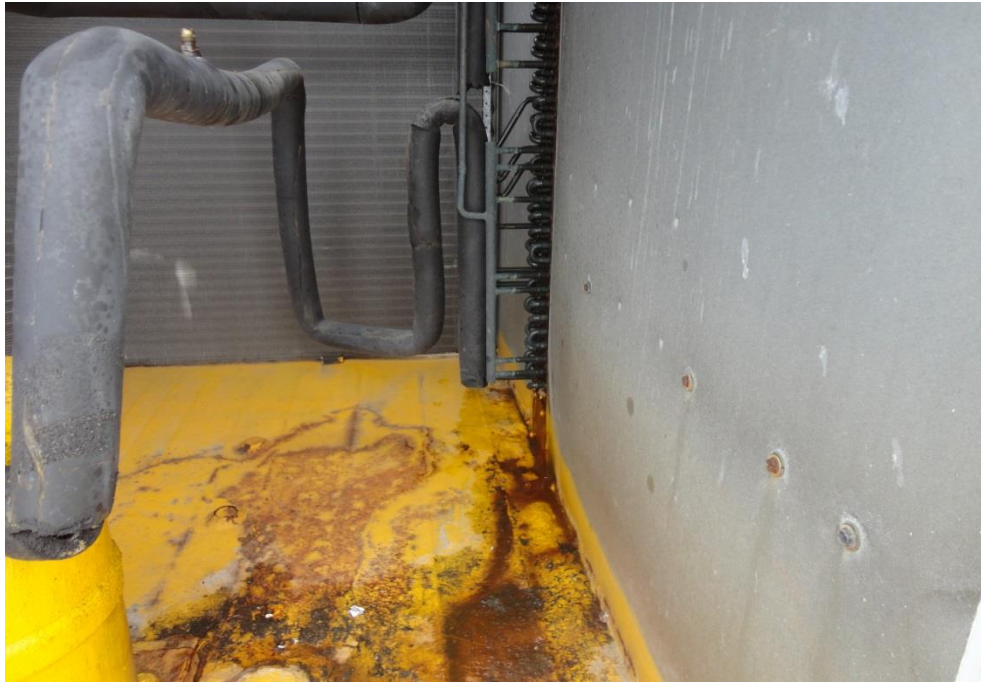
Foto 3.25. Presencia de corrosión en la charola de U.P-01
