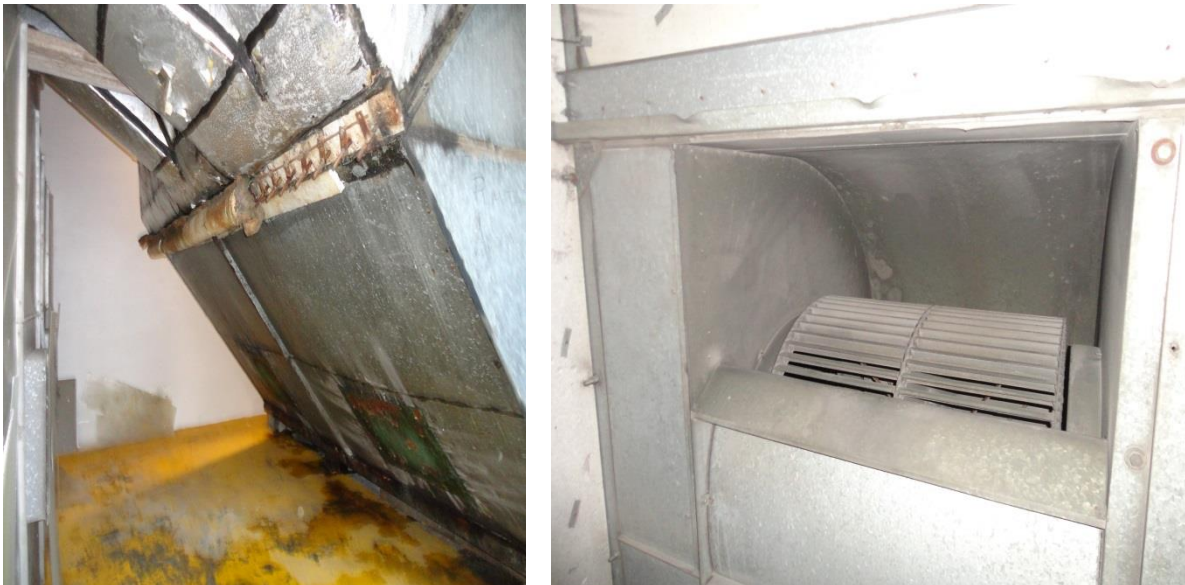
Foto 3.7. Fugas en las uniones de ductos y Revisión de turbina. (Fuente Levantamiento Aeropuerto Tampico)
