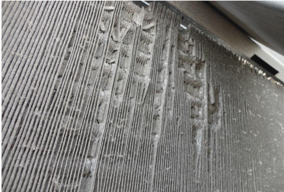
Foto 3.18. Presencia de lodo, aletas rotas y obstruidas U.C-08.
