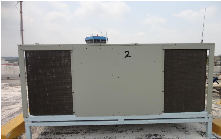
Foto 3.9. Gabinete de U.C-02 en buen estado. Serpentines con corrosión y lodo.
