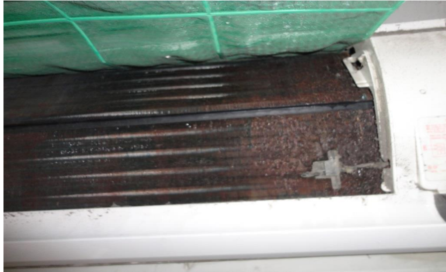
Foto 3.28. Serpentín de Unidad Evaporadora en mal estado M.S-02 (Fuente Levantamiento Aeropuerto Tampico)
