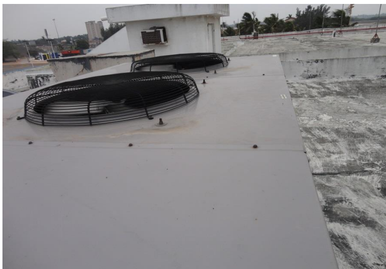
Foto 3.15. Aspas del ventilador en buen estado y limpias. (Fuente Levantamiento Aeropuerto Tampico)
