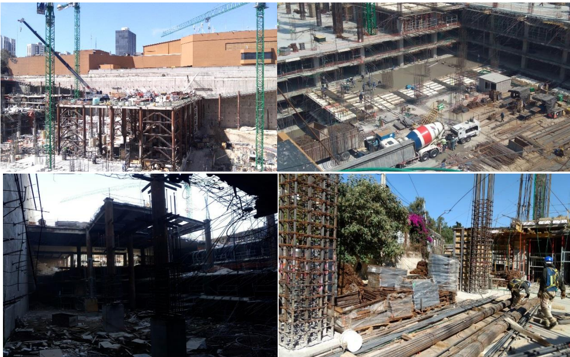
Figura 25: Falta de orden de materiales en obra . (Fuente:Blanca González , 2017)
