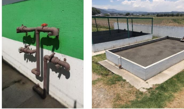
Figura 4 Llaves para el muestreo de lodos del reactor anaerobio usadas para purga de lodos y lechos de secado Fuente: Recorridos de campo
