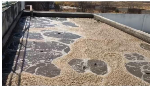
Figura 5 Reactor aerobio con espumas marrones y aireación no uniforme Fuente: Recorridos en campo
