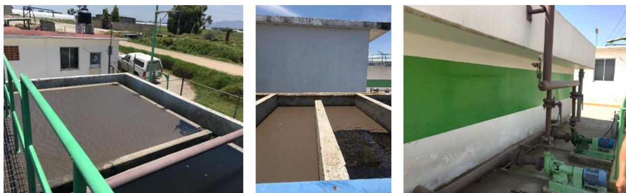
Figura 3 a y b) Sólidos flotantes en sedimentadores y tanque de desinfección c) tuberías de purga de lodos Fuente: Recorridos en campo
