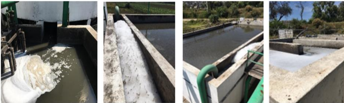
Figura 7 a) espumas en cárcamo de filtro percolador y b) espumas y sólidos en tanques sedimentadores c) espumas y sólidos en tanques de desinfección.
