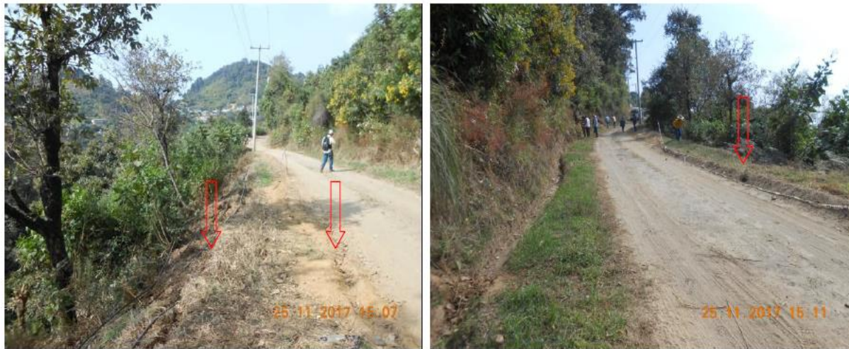
Foto No. 9.- Otras vistas de la geometría del camino y la ubicación de las grietas cercanas al hombro del talud. En la foto de la izquierda se observan una gran cantidad de mangueras que conducen agua potable desde depósitos hacia la zona de riego de las parcelas o para suministro de las viviendas ubicadas agua abajo. Se observaron muchas mangueras con fugas de agua así como caídos en el talud de la parte alta del camino, según se aprecia en las siguientes fotografías.
