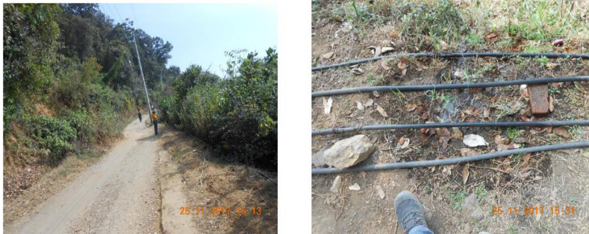
Foto No. 10.- Se observaron muchas mangueras con fugas de agua así como caídos en el talud de la parte alta del camino, según se aprecia en las fotografías.
