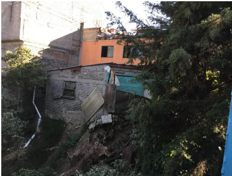
Figura 10. Casas aledañas al río que corren riesgo de colapsar
