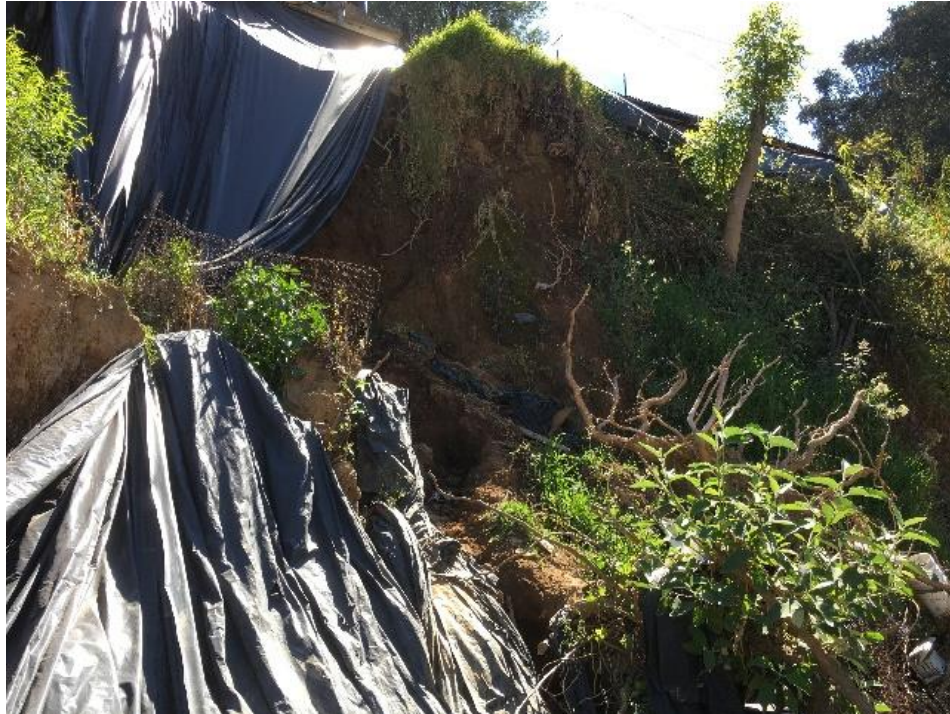
Figura 5. Talud deslizado, con presencia de árboles caídos
