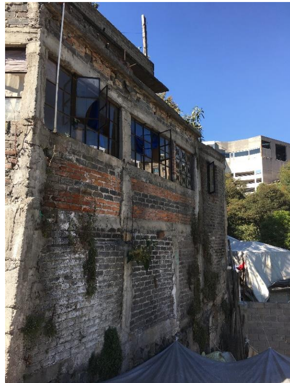
Figura 7. Casa afectada por los deslizamientos de suelo
