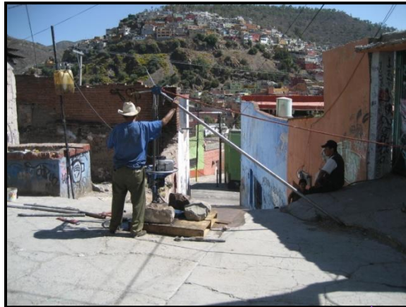
Fig. 15 Perforación en la esquina de Peñuñuri y Observatorio (sondeo 2 ▲), en donde se puede apreciar hacia el SE de la zona siniestrada, las marcadas pendientes topográficas.
