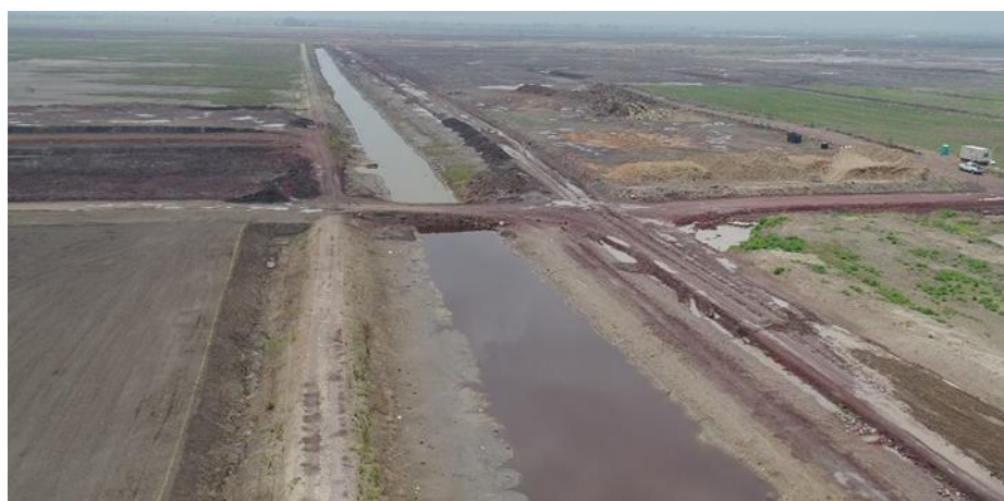
Figura 4.3 Obstrucción en el Dren secundario Canal 4 que conecta al DPTM-3 con el DPTM-2.
