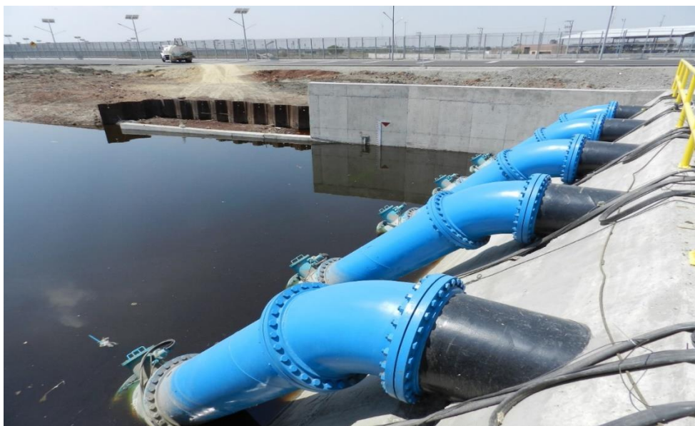
Figura 2.7 Planta de Bombeo PB-3 LRCC-DTN
