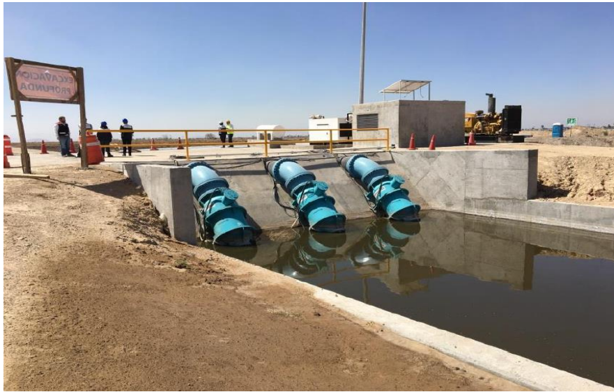
Figura 2.4 Planta de Bombeo PB1, Dren 1 (DPTM-1).
