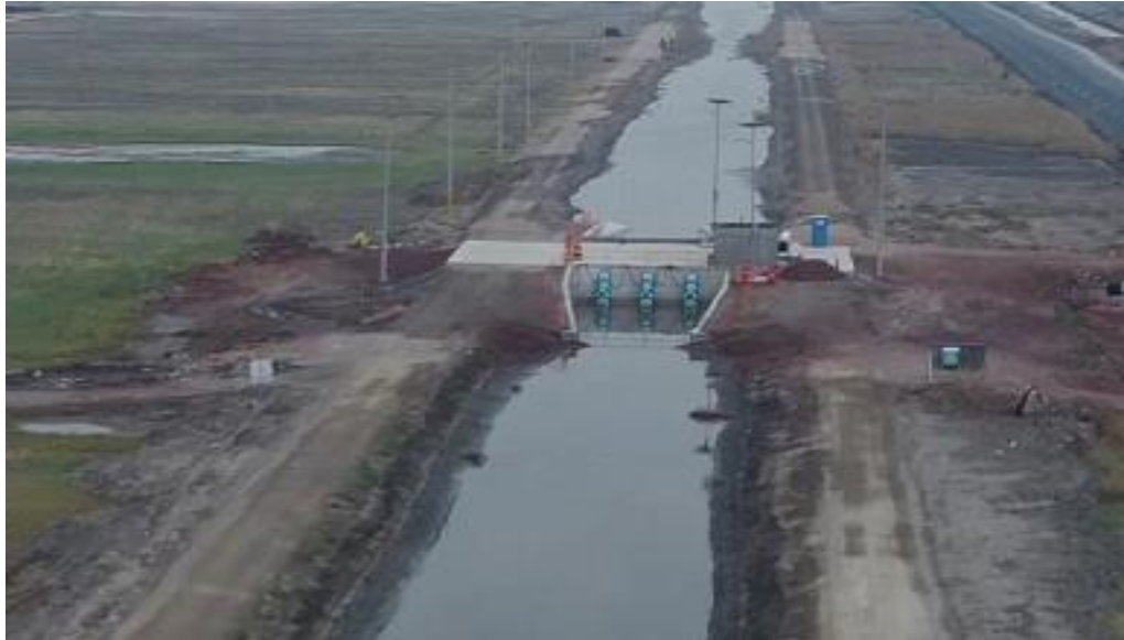
Figura 2.6 Planta de Bombeo PB-2, Dren 2 (DPTM-2).
