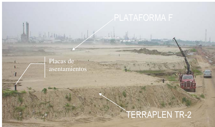
Figura No. 9.1. TR-2 totalmente construido. La “plataforma F” que se señala corresponde con los rellenos definitivos ubicados al norte-orienté del TR-2.
