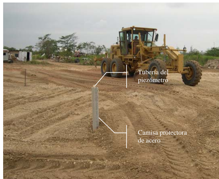
Figura No. 8.2 Arreglo de la protección de acero para la tubería vertical del piezómetro Al fondo se ve el equipo de construcción del terraplén.
