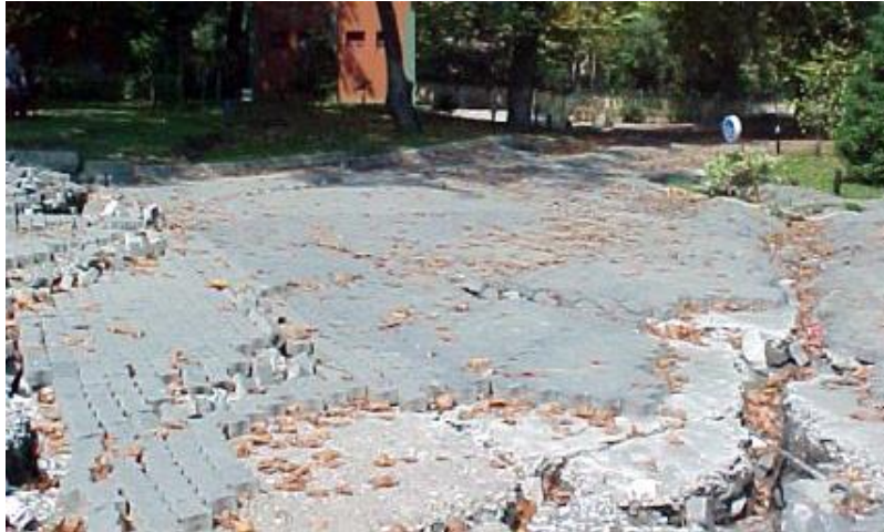
Figura 1.2. Desplazamientos laterales observados en el estacionamiento del Hotel Sapanca (Aydan et al. , 2004).
