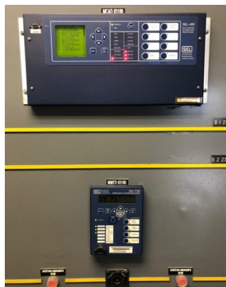
Figura 21. Equipo instalado en tablero de caseta de control
