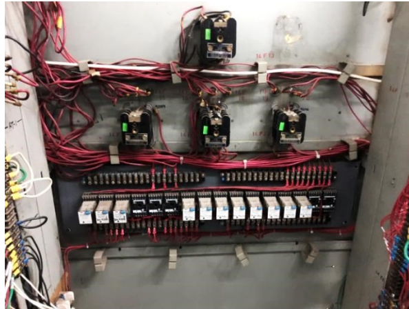
Figura 11. Controles de Interruptor electromecánicos
