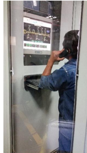
Figura 9. Fotografías que muestran el proceso de pruebas de la protección diferencial de barras. En estas pruebas se validan los disparos de la protección 87B en barras 1 y barras 2 con todas las bahías asociadas a la protección, alarmas de la protección 87B, alarmas del tablero y bloqueos al cierre por la protección 86B en conjunto con el Departamento de Control a nivel local, con Programación y con el Área de Control.
