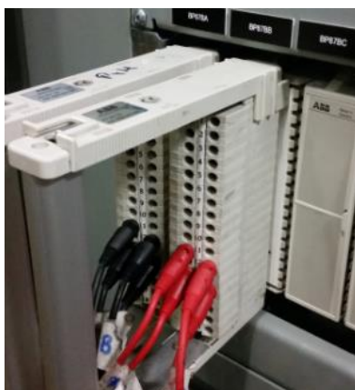
Figura 12. Fotografía del block de pruebas y la peineta marca ABB.
