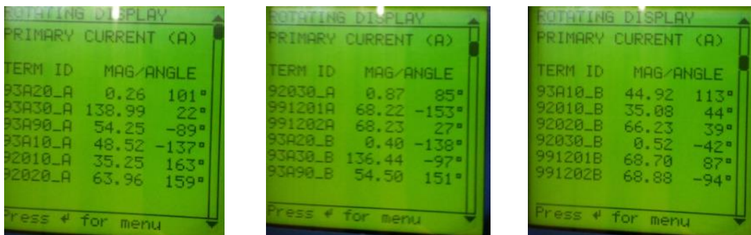
Figura 33. Fotografía que muestra el faseo de corrientes de las fases A y B.
