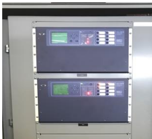
Figura 7. Fotografía de dos relevadores SEL-487 montados en el tablero.
