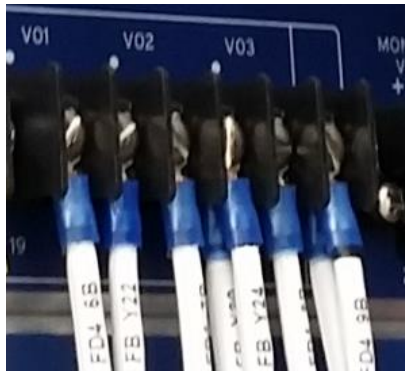
Figura 22. Fotografía de puntos de conexión y etiquetado.
