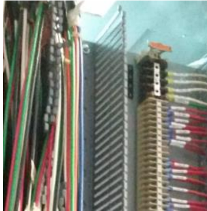
Figura 27. Fotografía del peinado de los conductores.
