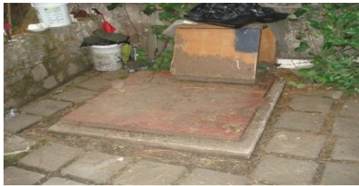
Fig.35 Registro de alta tensión.
