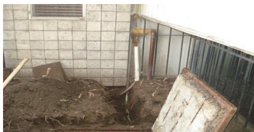
Fig.50 Registro cubierto por tierra.
