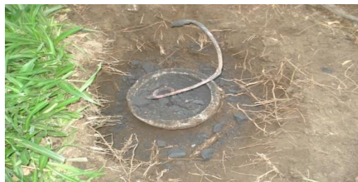
Fig.52 Varilla de tierra sin conectar.
