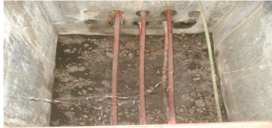
Fig.36 Varilla de tierra en registro de alta tensión.
