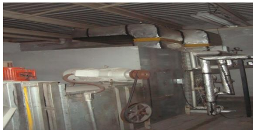
Fig.53 Equipos de clima sin referencia a tierra.
