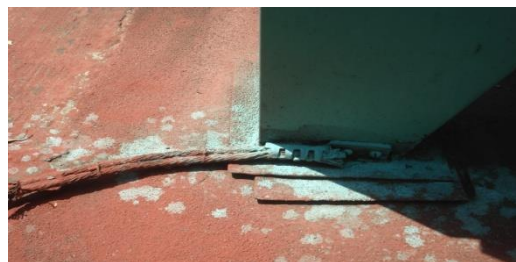
Fig.41 Terminal a compresión fuera de norma.
