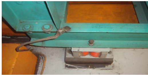
Fig.11 Patín del grupo electrógeno 2
