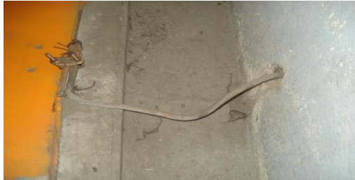
Fig.24 Derivación a sala de tableros
