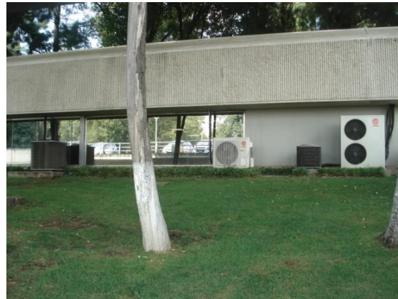
Fig.56 Equipos instalados fuera del edificio sin su referencia a tierra.
