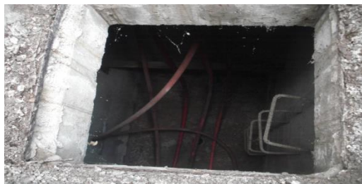
Fig.38 Cables de energía en registro.
