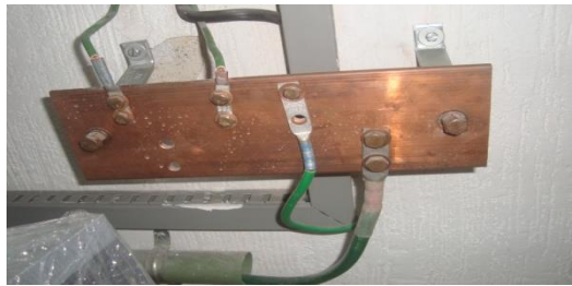
Fig.27 Barra de tierra en oficinas
