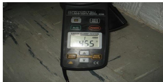
Fig.29 Lectura de sistema de tierras en oficinas.
