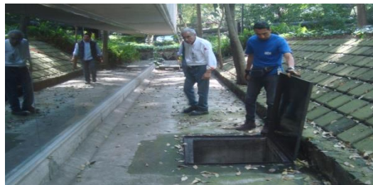
Fig. 48 Registro con varilla de tierra a estructura.
