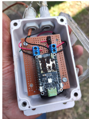
Figura 5.14: Deterioro del nodo terminal después de seis meses de operación.
