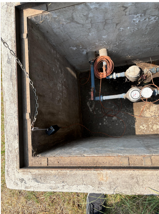
(c) Colocación del nodo con medidor
