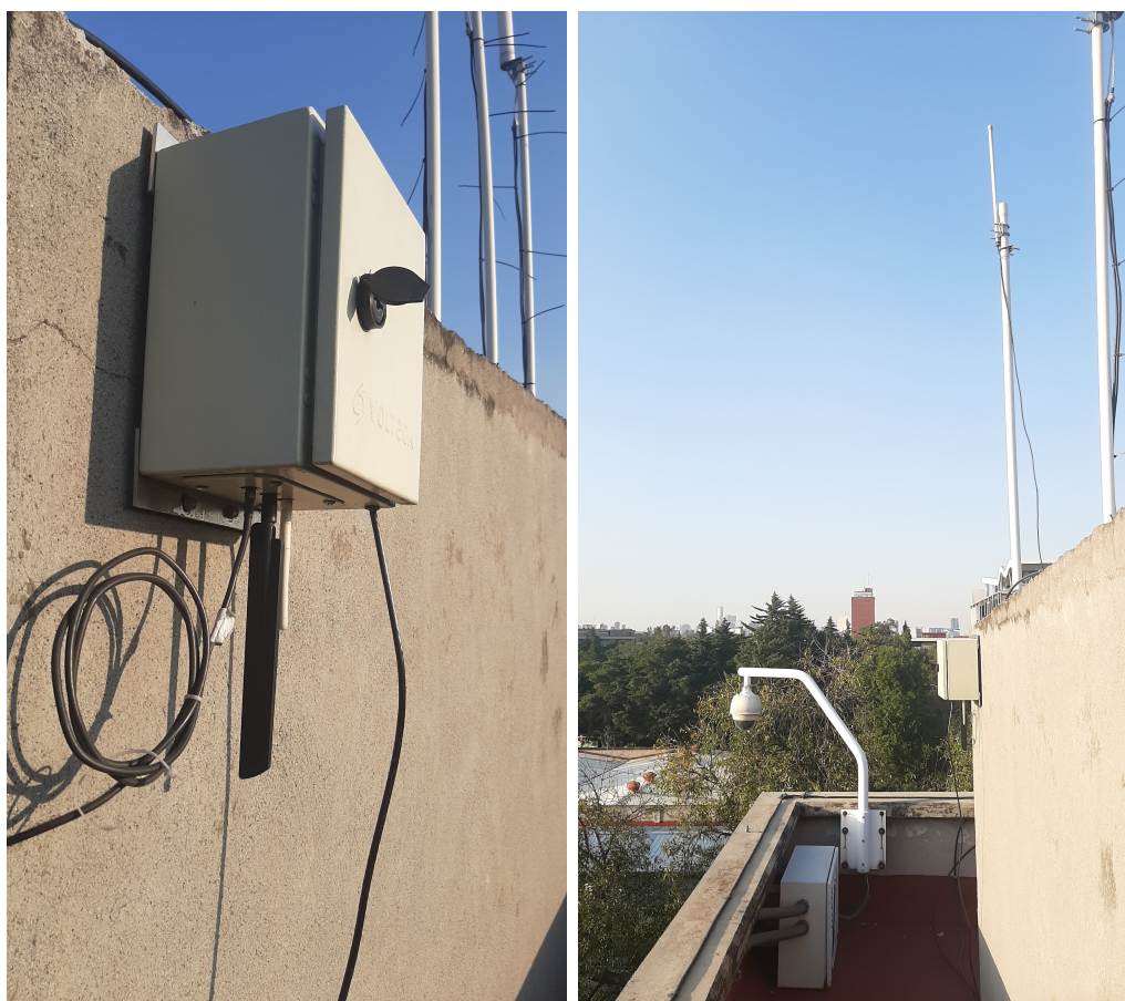
(a) Gabinete de protección con salida de las antenas Wi-Fi y 4G. (b) Perspectiva de vista del Gateway e instalación de la antena LoRa.
