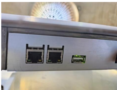
Imagen 2_ Puertos del HMI.
