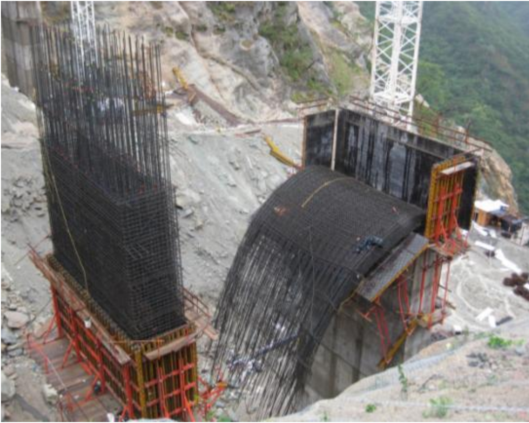
Figura 5.12. Daños ocasionados por el huracán Rick en el armado de una de las pilas del puente especial Baluarte
