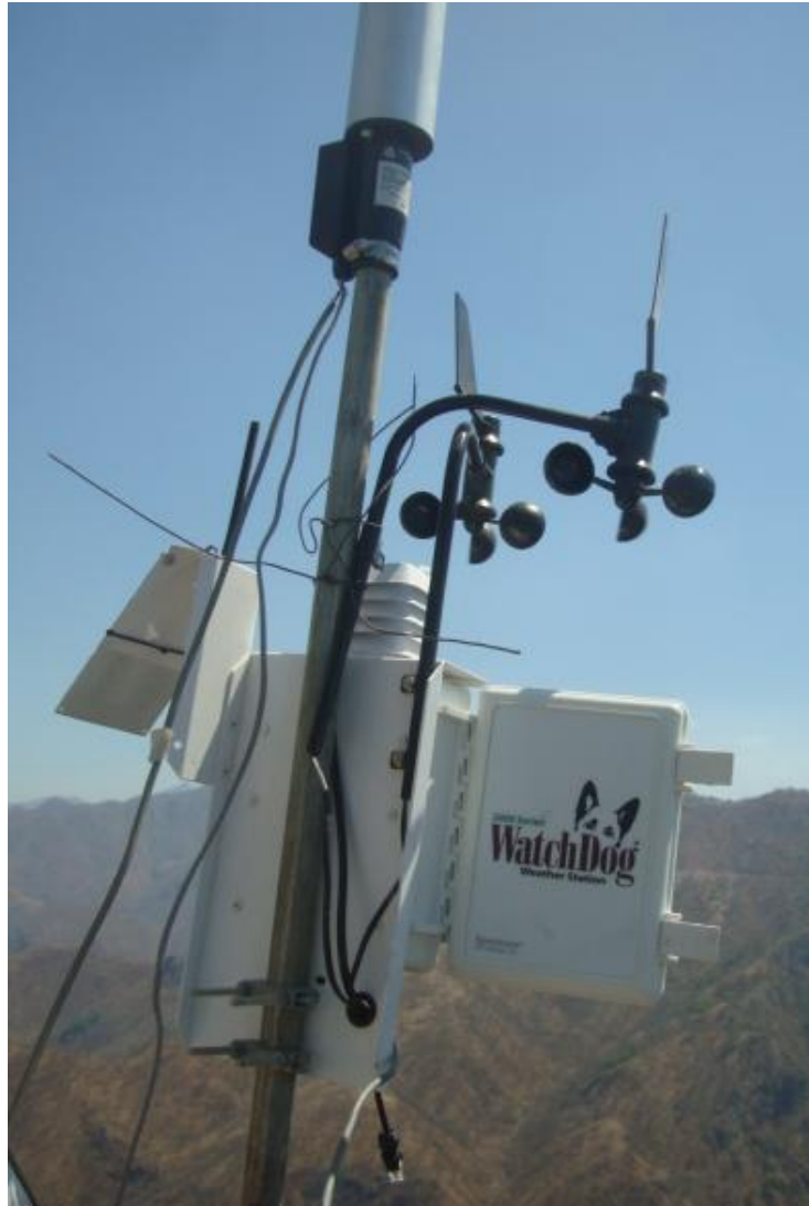
Figura 5.2 Estación meteorológica colocada en la vigas de lanzamiento de ambas márgenes
