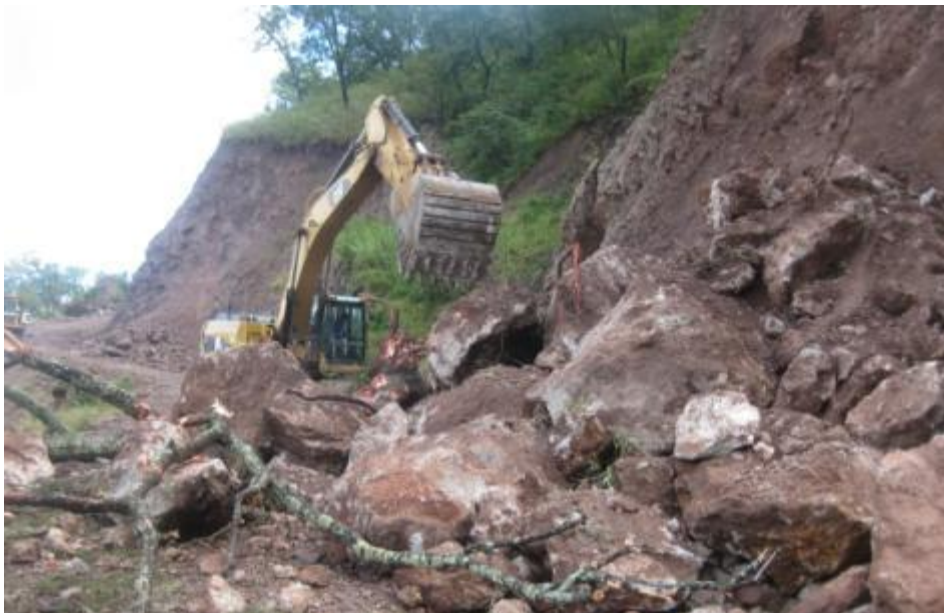
Figura 5.15. Deslave en los caminos de acceso al puente Baluarte ocasionado por las fuertes ráfagas de viento
