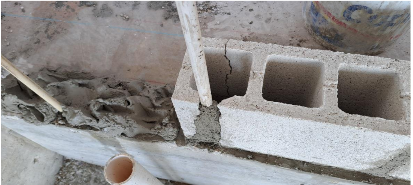
Block despostillado y rajado con junteo incorrecto.
