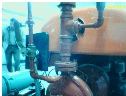
Vista frontal de la descarga de la bomba con motor de combustión interna
