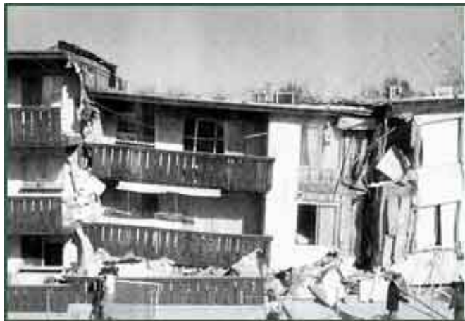
Figura 17 Edificio Meadows después del sismo de Northridge 1994 baumhedlundlaw (2010)
