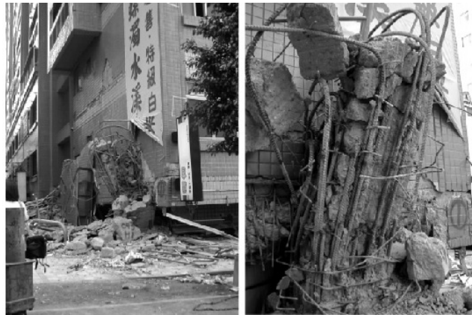
Figura 15 Fotografías de Taichung New World Center Naeim et al. , (2000) se muestra la sección donde se ve que el lado que no falló y qué lado sí falló, e se muestra el colapso del segundo piso sobre el primero y en c) un detalle de una columna
