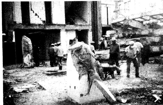
Figura 5 Se ve el interior del edificio de ministerio de planeación después de colapsado el edificio, en b) una imagen que muestra al mismo edificio de planeación cuyas columnas no tenían el adecuado refuerzo Raymond et al., (1987)
