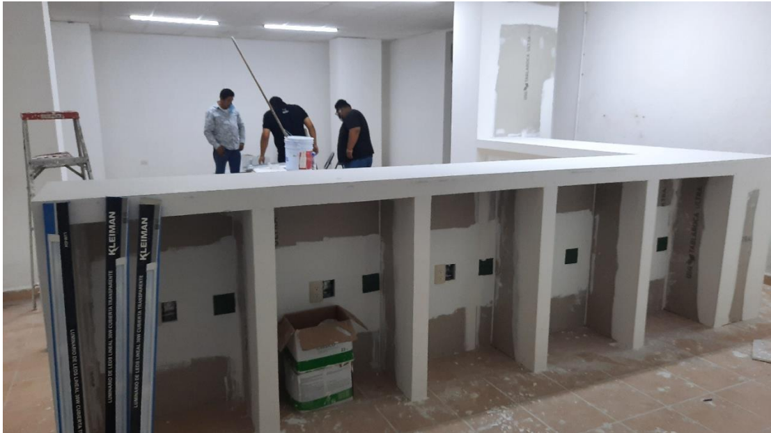
Foto 6 Construcción de mesa de trabajo de Tablaroca en la oficina de Migración de Beta Tapachula Chiapas INM Colección personal del autor
