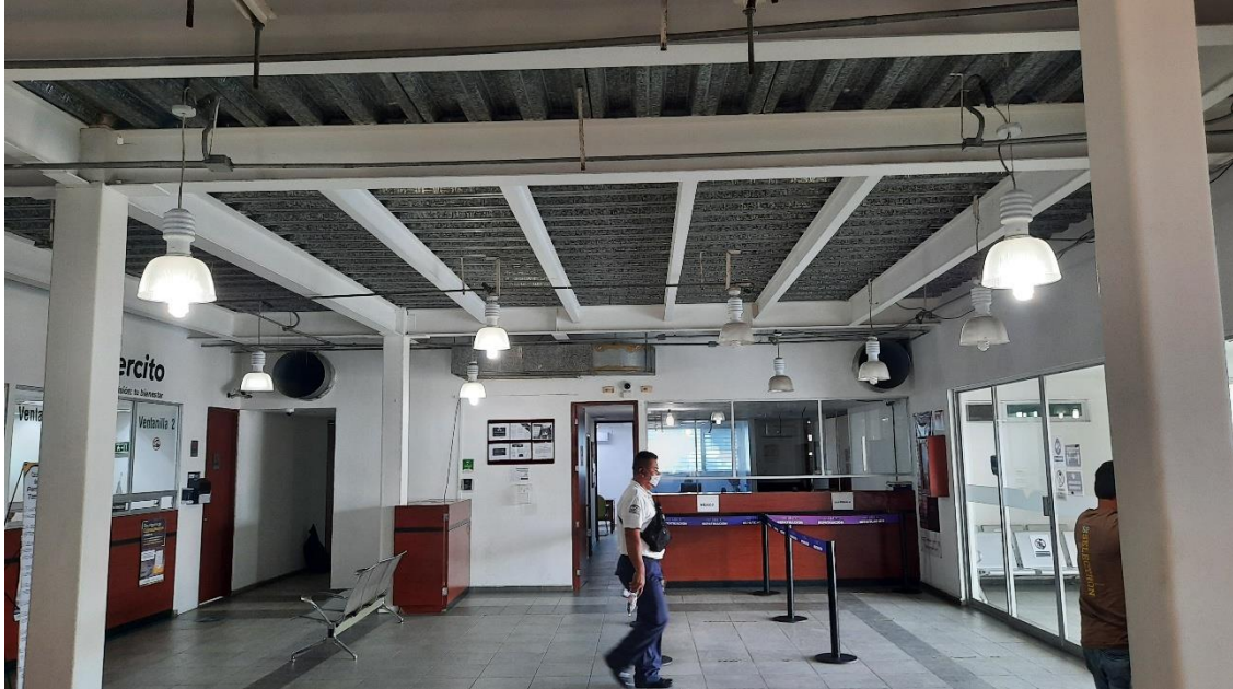
Foto 8 Lámparas Antes de los trabajos en la oficina de Migración de Suchiate 1 Chiapas INM antes de realizar los trabajos
