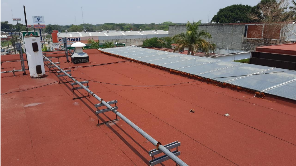
Foto 14 Azotea en oficina de Migración en Palenque Chiapas INM, antes de realizar trabajos de impermeabilizante Colección personal del autor
