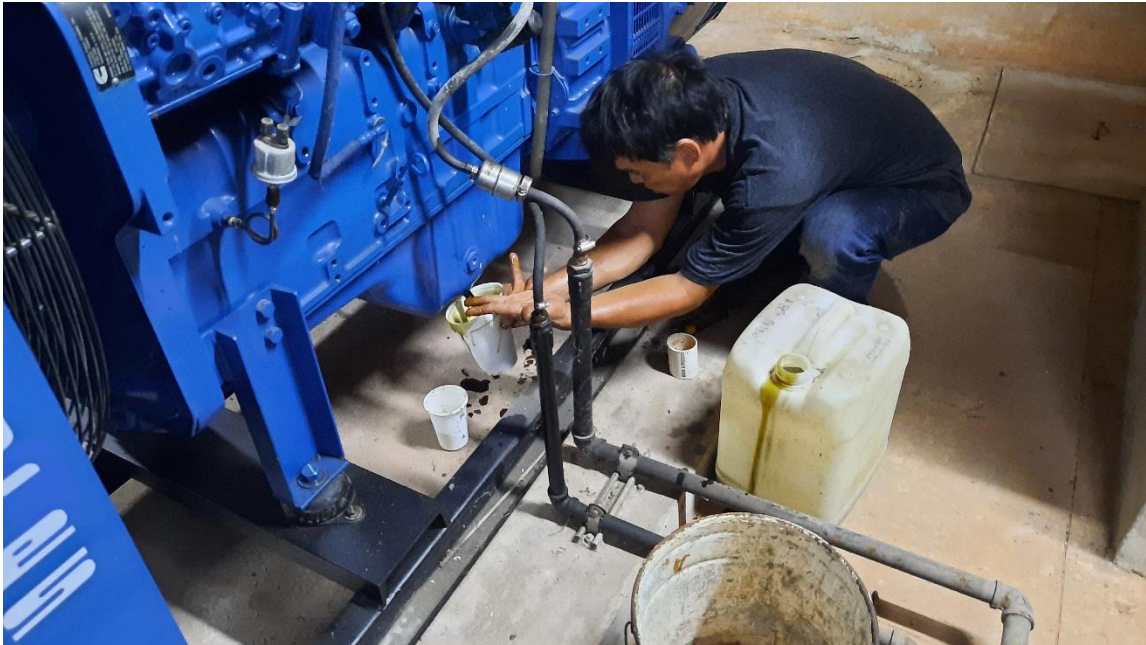
Foto 4 Mantenimiento a planta de emergencia en la oficina de Migración de Palenque Chiapas INM Colección personal del autor
