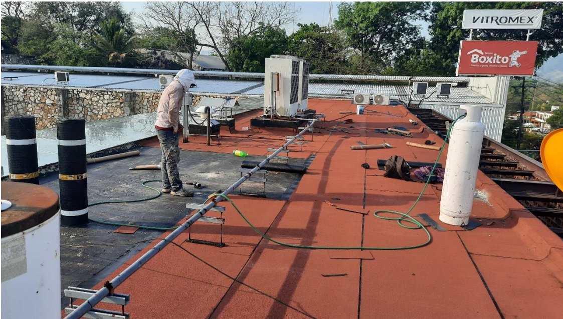
Foto 15 Azotea en oficina de Migración en Palenque Chiapas INM, durante el proceso de los trabajos de impermeabilización Colección personal del autor
