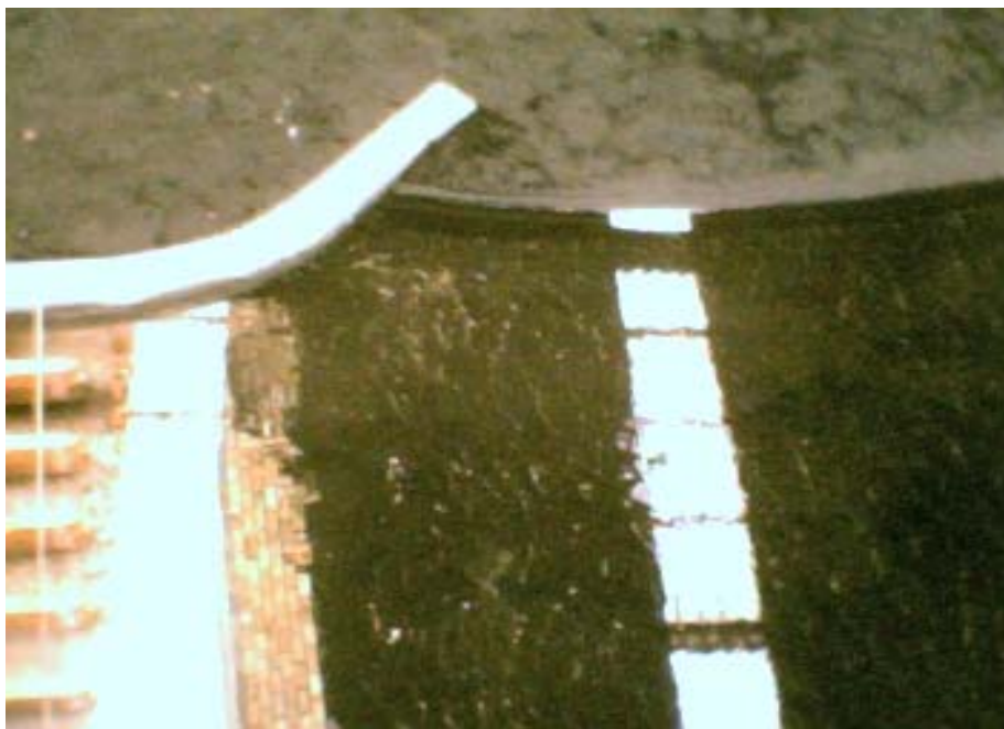
Fotografía 4.2.10 Detalle de hueco de socavación.
