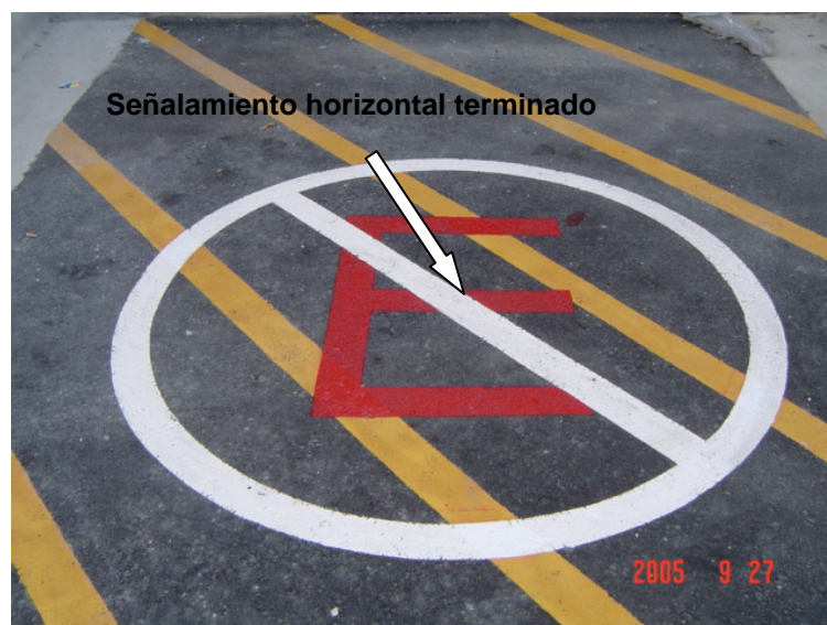
Foto III.6.3.3 Señal horizontal de no estacionarse.
