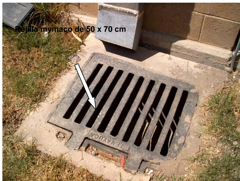
Foto III.4.3.1 Registro pluvial con rejilla de piso.
