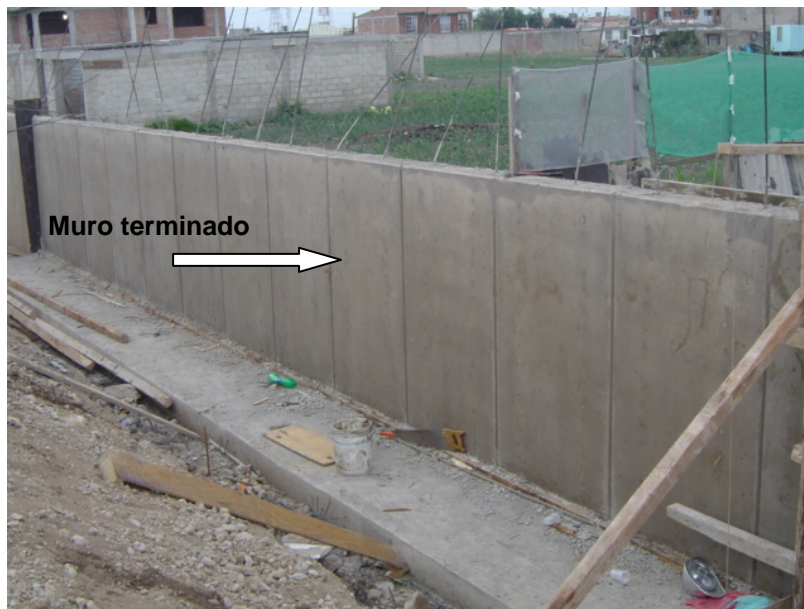
Foto III.3.2.3 Acabado al descimbrar.
