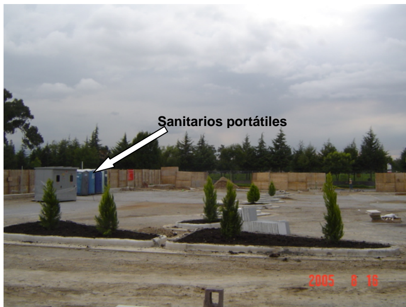
Foto. III.1.1.1 Servicio de sanitarios portátiles.
