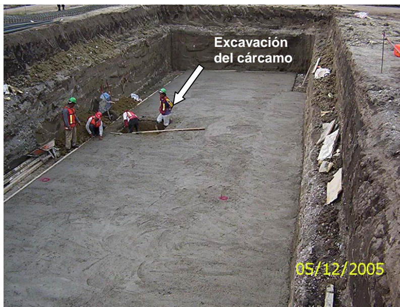
Foto III.4.4.3 Cárcamo de bombeo.
