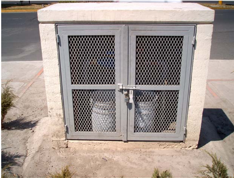
Foto. III.4.1.3 Gabinete del cuadro de acometida terminado.
