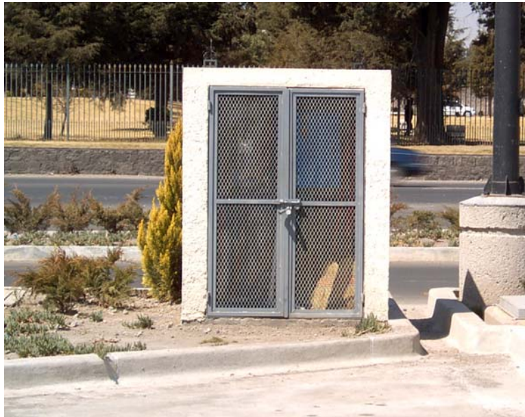
Foto III.4.4.10 Gabinete de mampostería del tablero de control.
