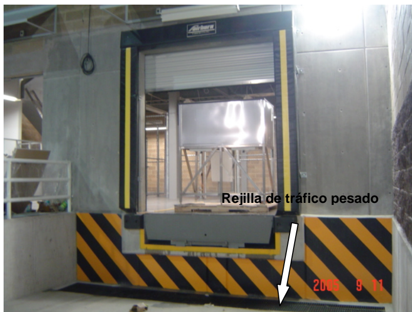
Foto III.4.3.3 Registro pluvial en anden de carga.
