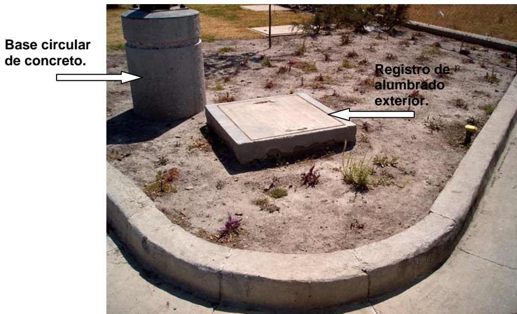
Foto III.5.3.1 Base de poste de alumbrado y registro.
