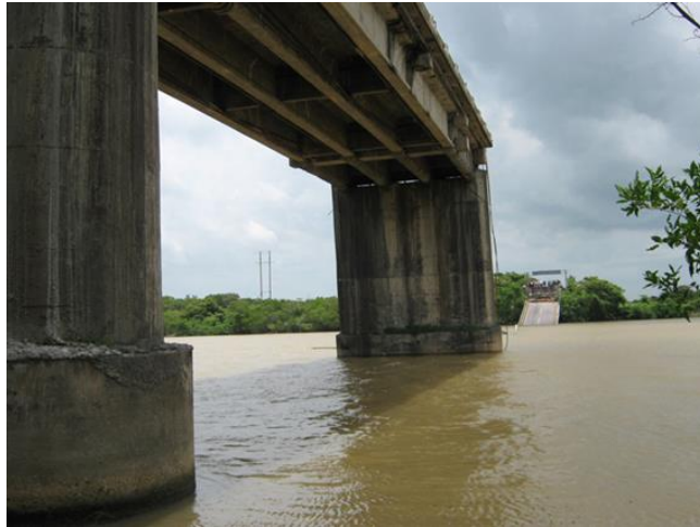
Ilustración 3 Restos del Puente Tonalá
