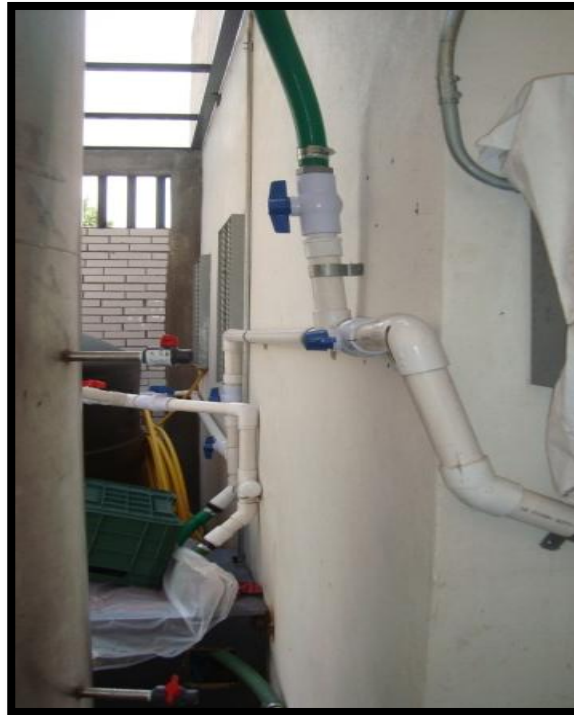
Figura 4. 5 Sistema de tuberías de los reactores anaerobios
