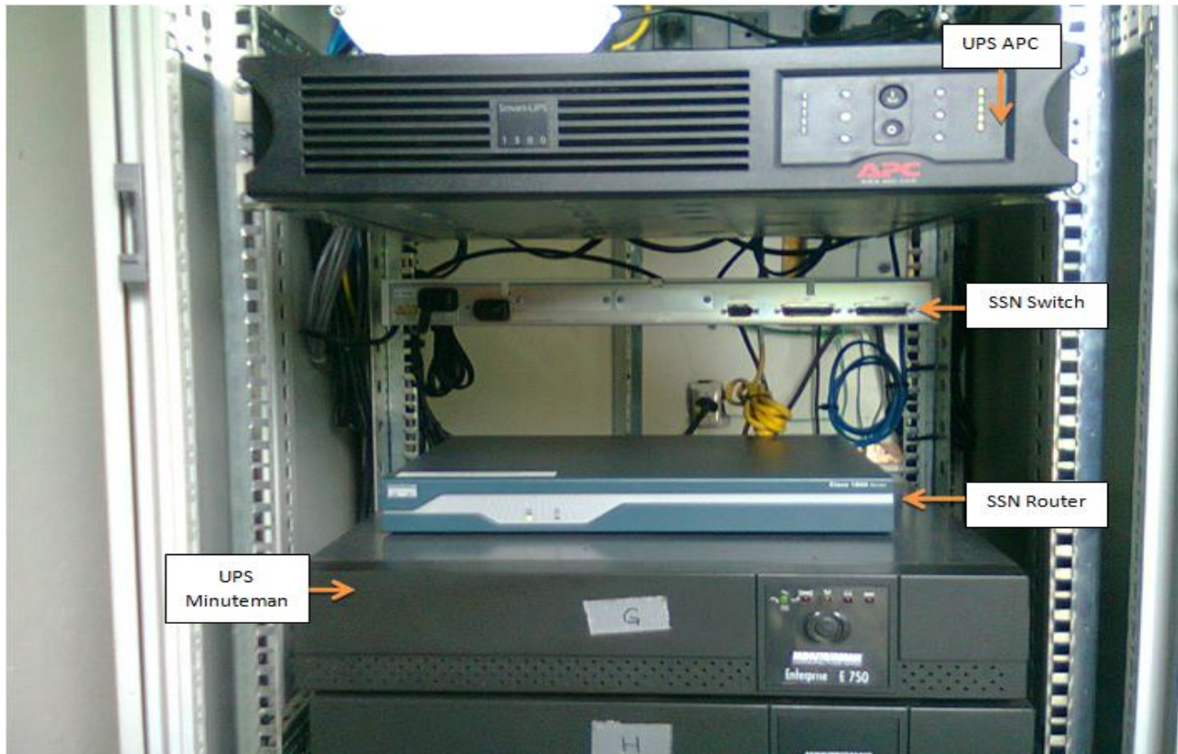
Figura 5.23. Vista frontal de equipos
