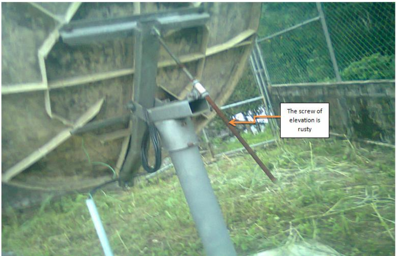
Figura 5.20. Tornillo de elevación de antena CTBTO
