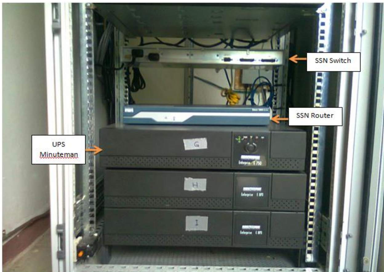
Figura 5.24. Continuación de la vista frontal de equipos
