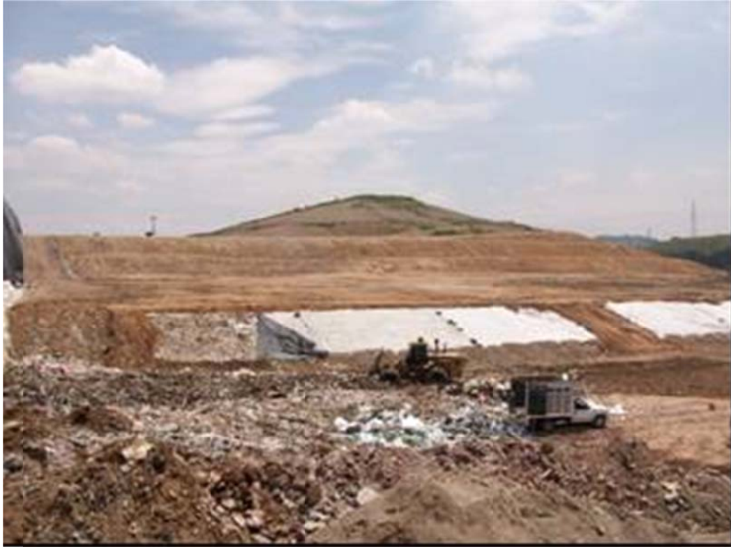
Imagen 8. Levantamiento de lonas. Relleno Sanitario de Naucalpan de Juárez, Estado de México.
