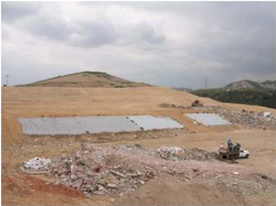
Imagen 7. Continuidad de lonas después de pozo de biogás. Relleno Sanitario de Naucalpan de Juárez, Estado de México.
