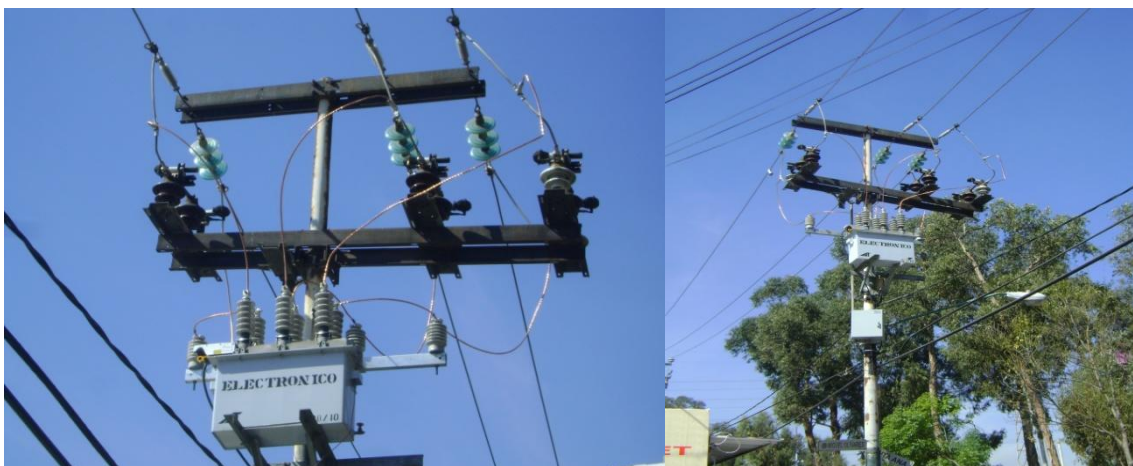
Figura 1.35 Poste de acero troncocónico A-17 con plataforma, y seccionador automático.
