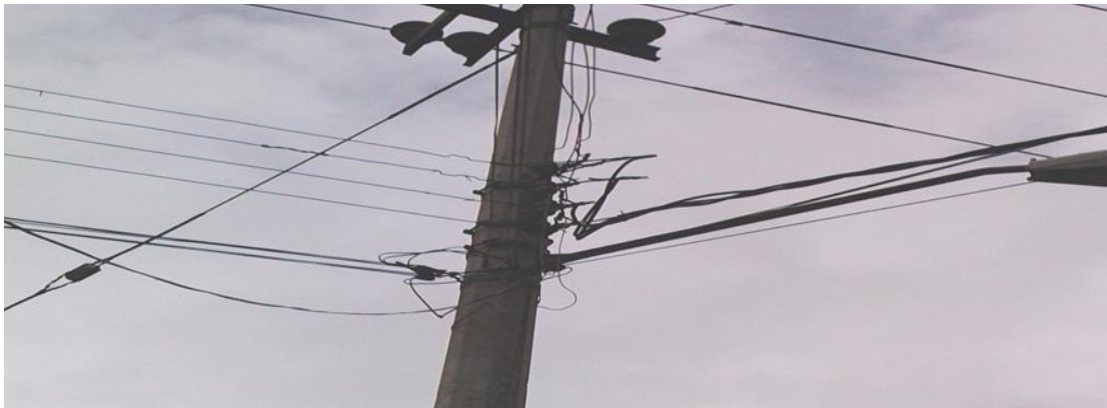
Figura 1.52 Transición de línea trenzada a línea abierta mejor conocida como red de distribución de baja tensión mixta.
