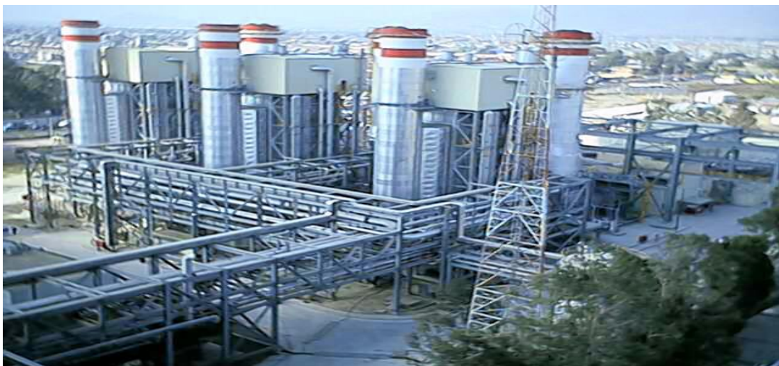
Figura 1.2 Termoeléctrica del valle de México ubicada en el municipio de Acolman del estado de México.
