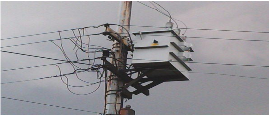
Figura 1.46 Salidas de transformador y tendido aéreo de línea abierta de distribución de baja tensión.
