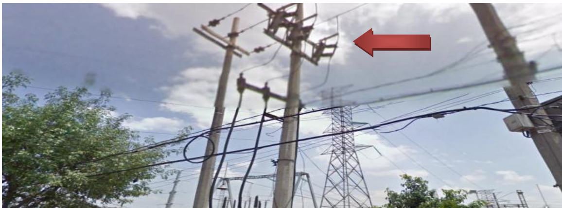
Figura 1.26 “Cuchillas” interruptoras primeras de salida de la subestación reductora San Ángel.
