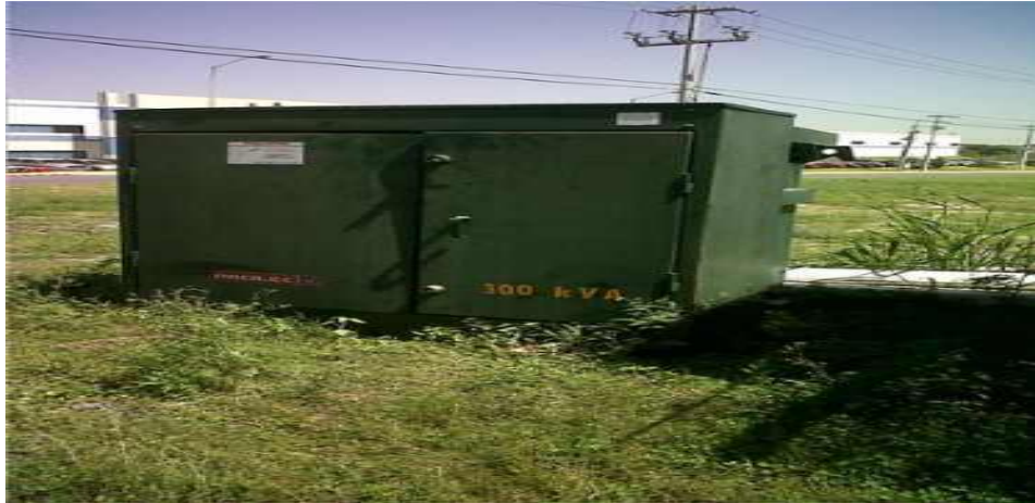
Figura 1.44 Transformador trifásico de pedestal.
