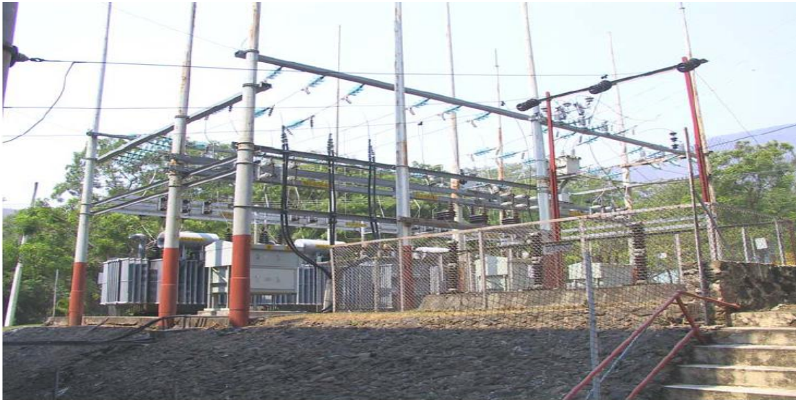
Figura 1.8 Subestación eléctrica reductora de intemperie.
