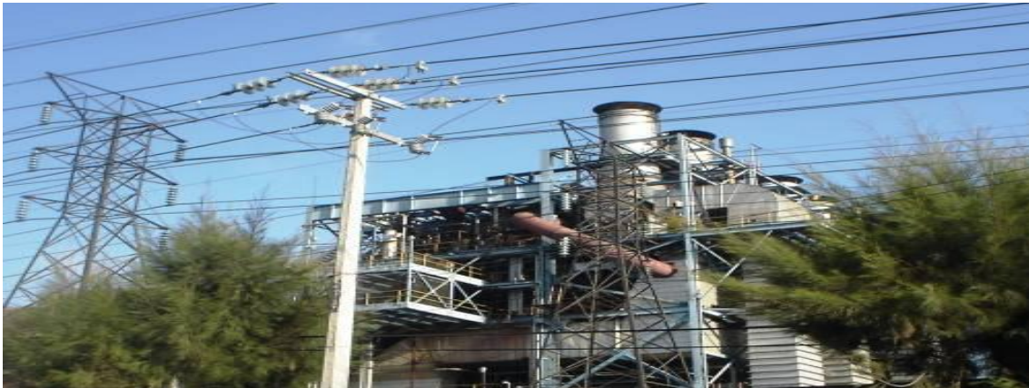
Figura 1.25 Central termoeléctrica Jorge Luque.
