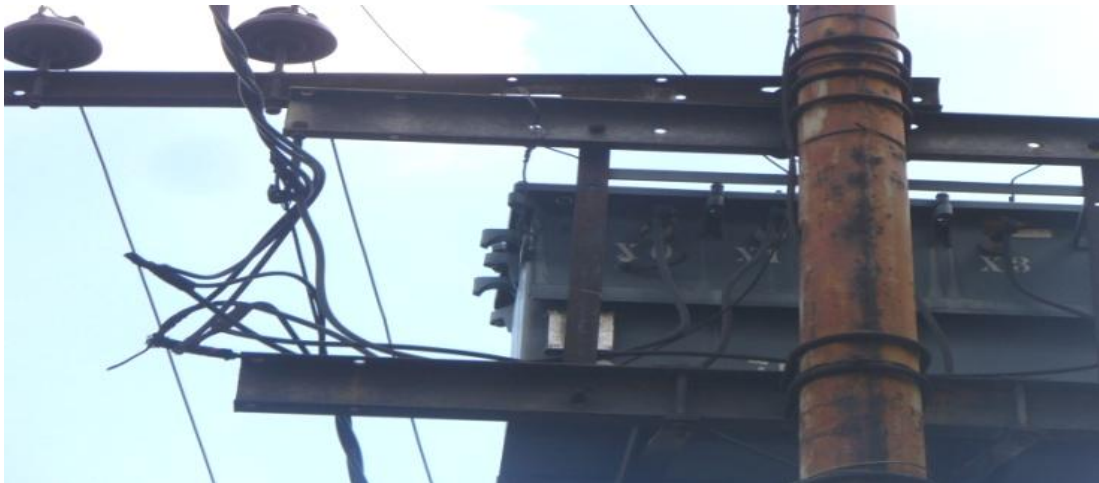
Figura 1.50 Cable trenzado de baja tensión de calibre de 1/0 en la salida de transformador trifásico aéreo.
