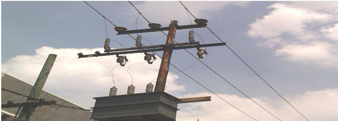
Figura 1.20 Transformador trifásico aéreo.
