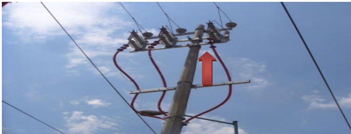
Figura 1.27 Primeras de salida de otro circuito de la subestación San Ángel.
