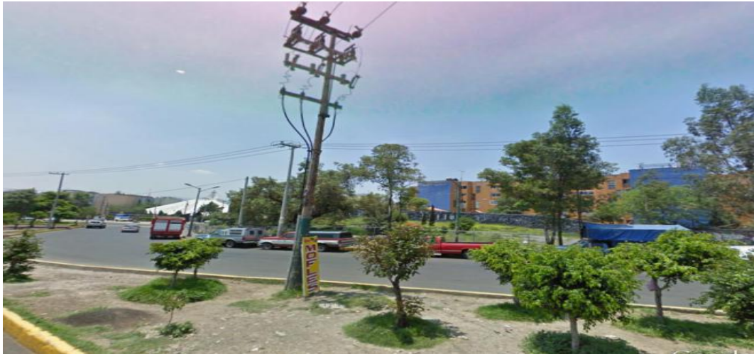
Figura 1.43 Mufa de alimentación de mediana tensión.
