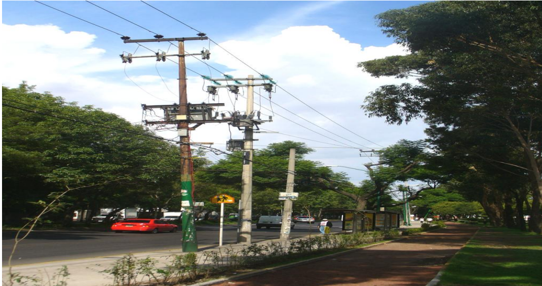
Figura 1.36 Tendido eléctrico e instalación de equipos en postes de acero y concreto.
