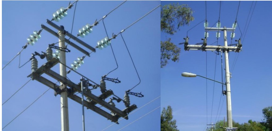
Figura 1.34 Poste de concreto reforzado con equipo manual de seccionamiento.
