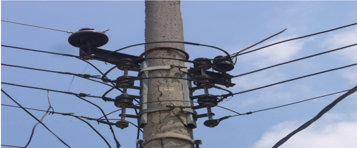
Figura 1.47 Red de distribución aérea de baja tensión.
