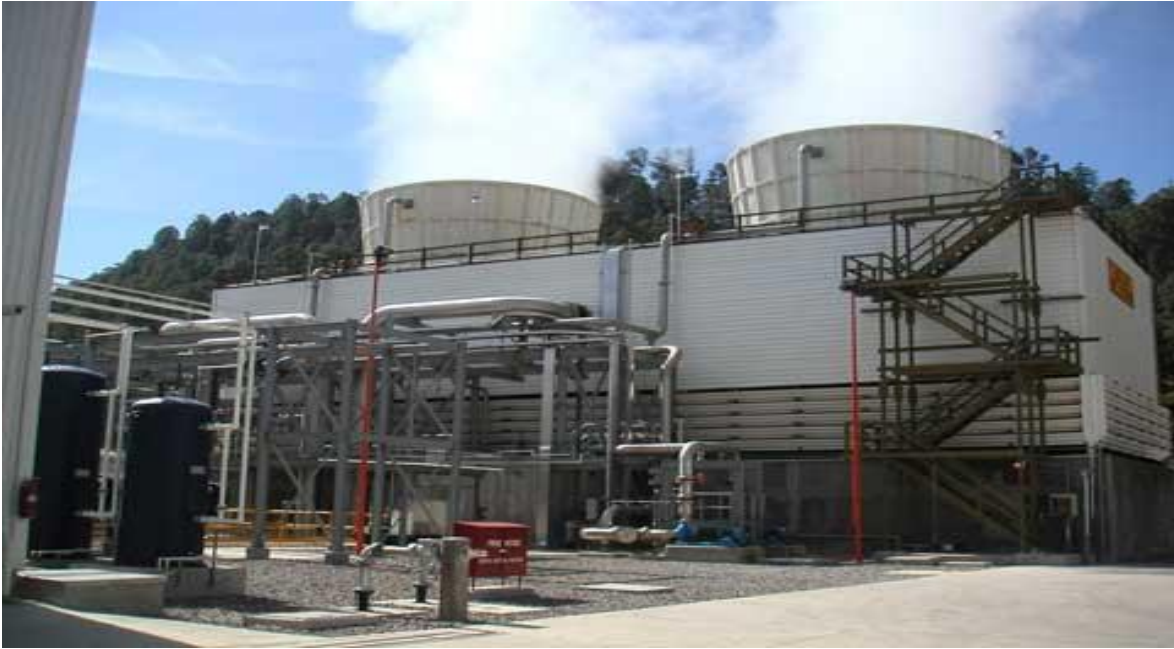
Figura 1.3 Geotermoelectrica los Azufres II ubicada en el municipio de Ciudad Hidalgo en el estado de Michoacán.
