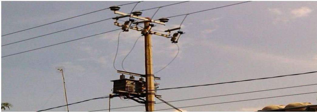
Figura 1.39 Transformador instalado en la red troncal.
