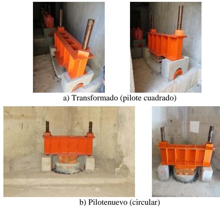
Figura 2.37 Pilotes de control en tanques de almacenamiento de turbosina.
