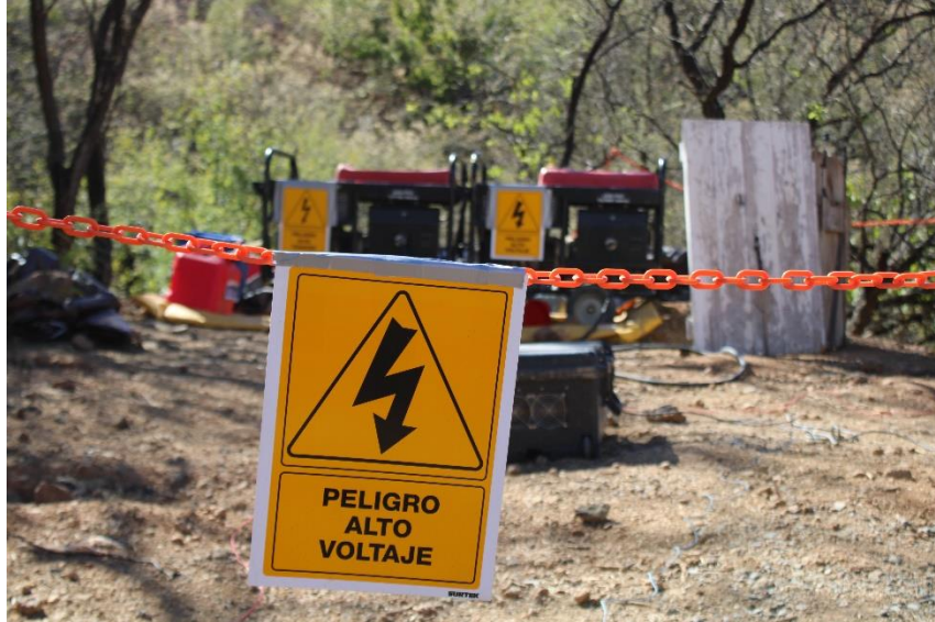
Fig. 3.5. Área del transmisor y generadores.
