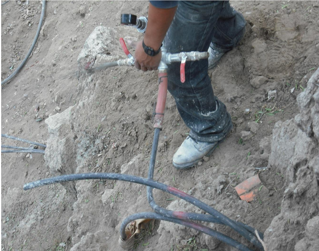
Figura 86. Adecuaciones en el equipo de inyección.
