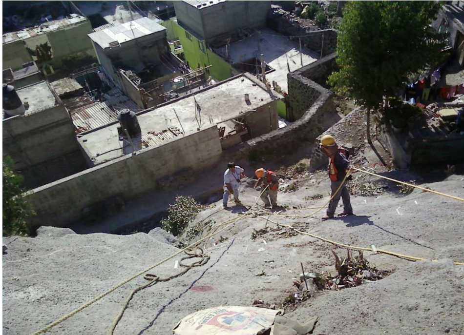
Figura 74. Ubicación en forma manual de los puntos para perforación y colocación de anclas de refuerzo.
