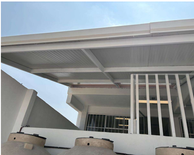
Cubierta de Multytecho en cubo de ventilación
