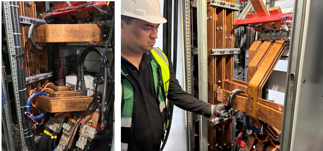
Figura 4. Tablero de sincronía RAMAL 1, conexión de interruptores mediante barras de cobre.
