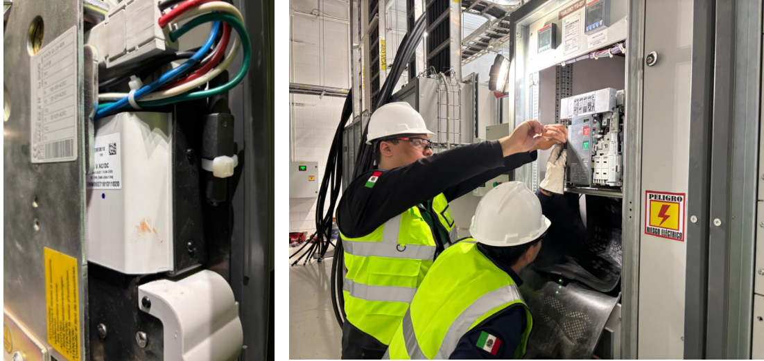
Figura 3. Tablero de sincronía RAMAL 1, modificación de elementos de control..
