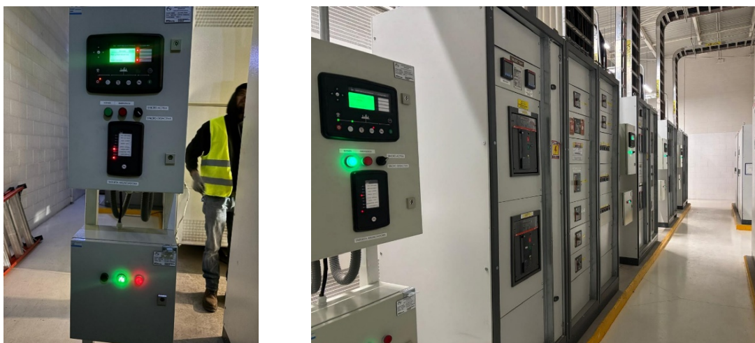
Figura 2. Tablero de sincronía (izquierda), tablero de transferencia y carga (derecha), 04 bloques en total.
