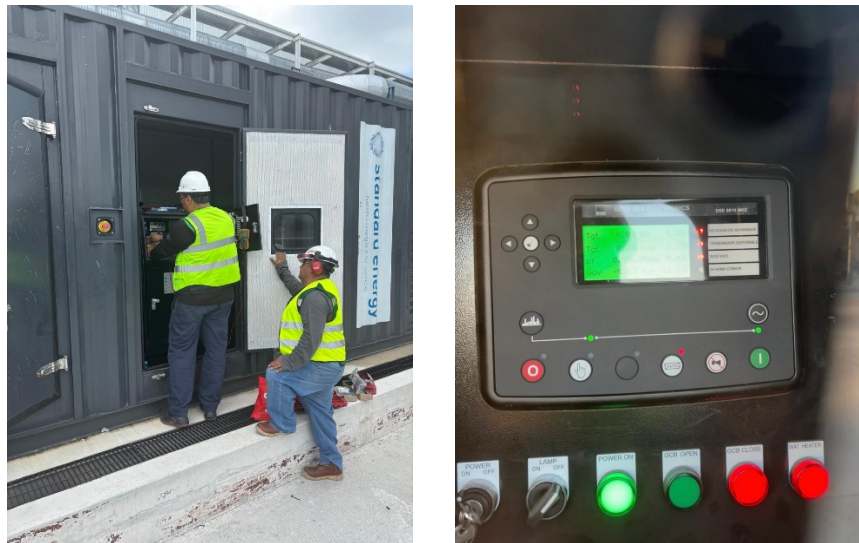
Figura 5. Modulo de control DSE 8610 Esclavo ubicado en la planta de emergencia al exterior del cuarto de maquinas..
