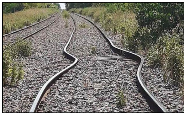
Figura 13. Pandeo lateral en una vía de Sarmiento, Argentina. (Crónica Ferroviaria, 2024)
