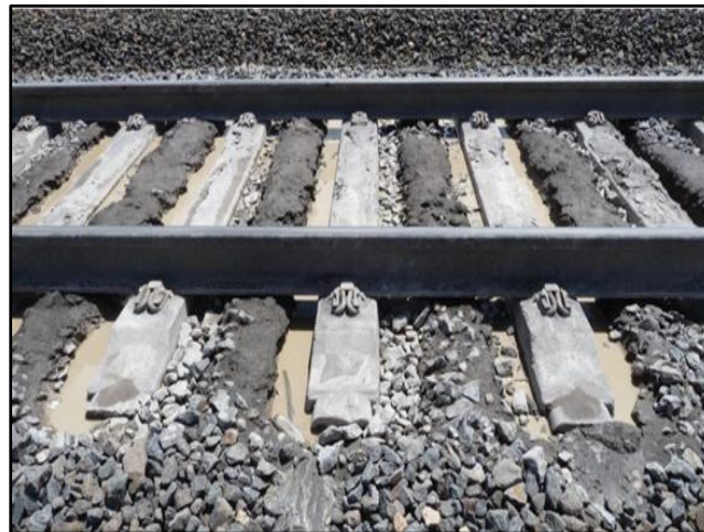
Figura 11. Encharcamiento de agua en el balasto a lo largo de un tramo de vía. (Australian Transport Safety Bureau, 2012)
