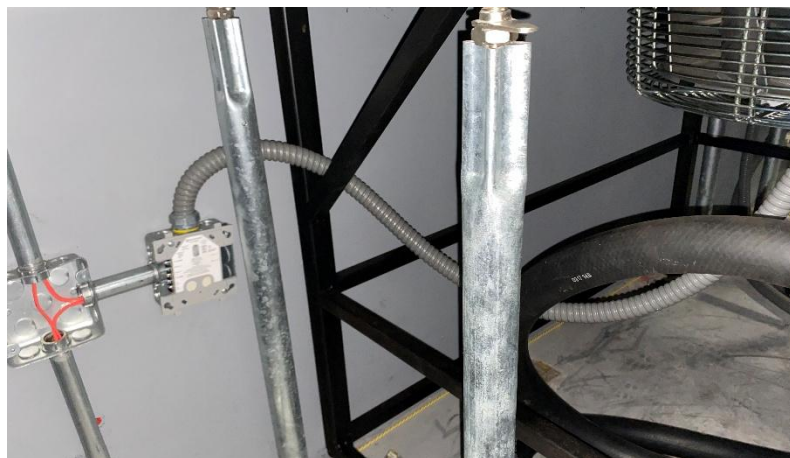
Instalación módulos relay (incluida la canalización) del sistema contra incendio conectados a las 14 UMA's del centro de datos.
