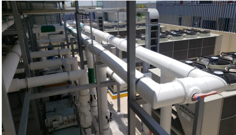
Ejemplo del sistema de enfriamiento a base de agua helada. En la imagen se aprecian equipos chiller, sistema de bombeo de agua helada y la red de tubería hacia el centro de datos.
