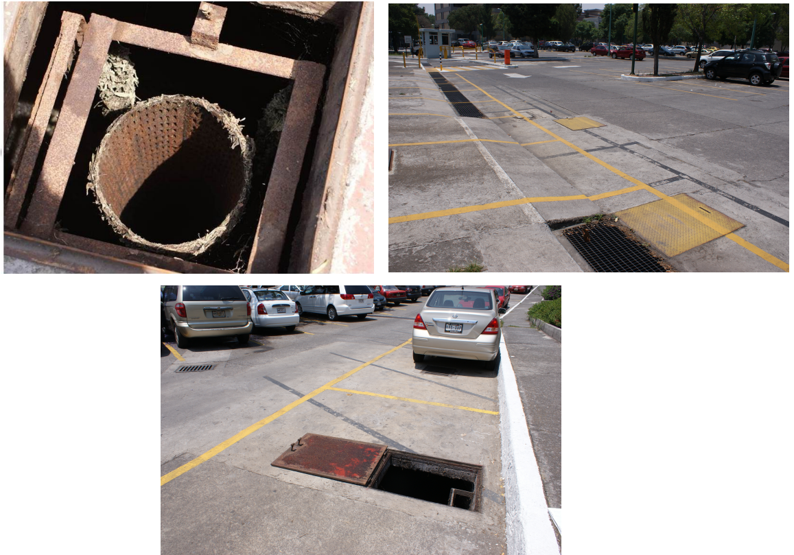
Figura 4.3.- Ademe y proceso de infiltracion Pozo de absorción de “Filosofía y Letras”, Abril 2012
