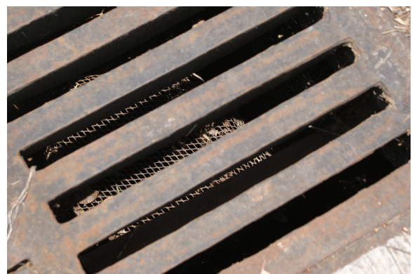
Figura B28.- El Pozo de Beisbol cuenta con canaletas sin rejilla, teniendo obstrucción de restos orgánicos
