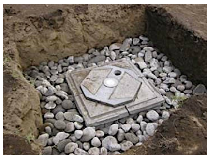
b) Vista de un pozo de absorción prefabricado
