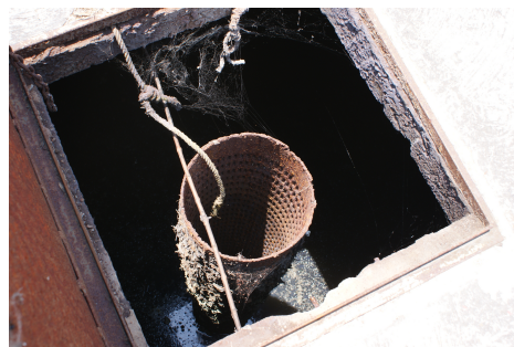
Figura B23.- Ademes de conducción, obsérvese el estado de los dispositivos
