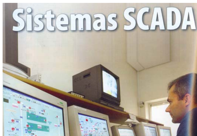
Fig. 4.2 Supervisión de los parámetros de la planta.
