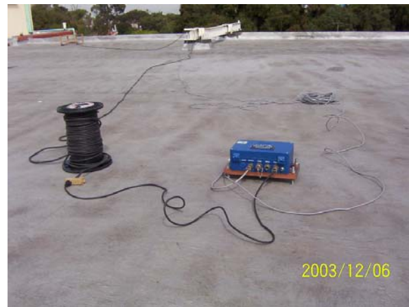
Figura 3.6 Detalle de instrumento instalado en el techo
