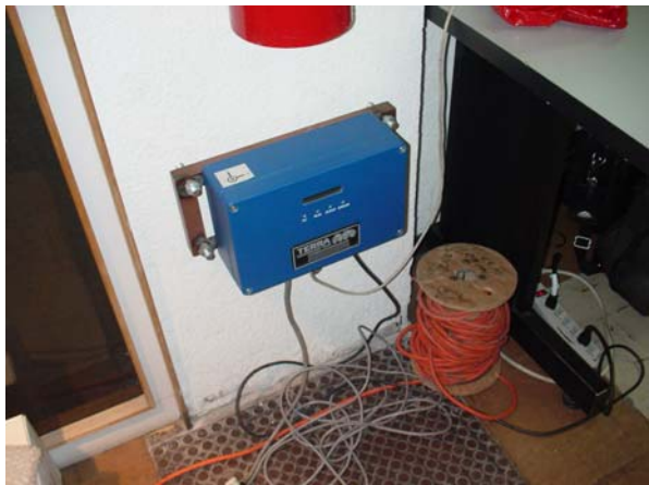
Figura 3.3 Detalle de instrumento instalado en la planta baja.
