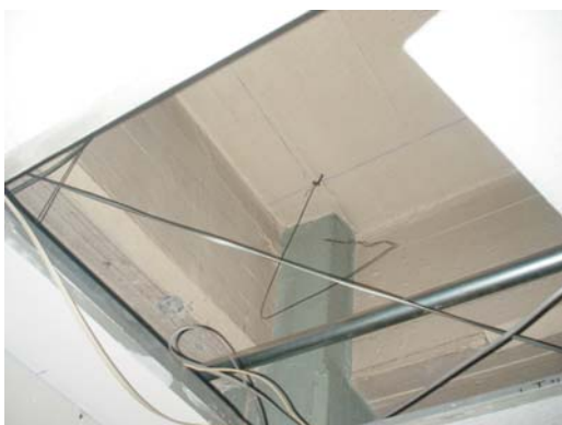
Figura 2.5 Detalle de agrietamiento en traveses en nudo
