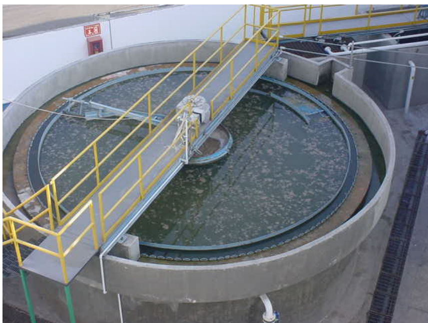
Figura C.18 Filtro Sedimentador en funcionamiento.
