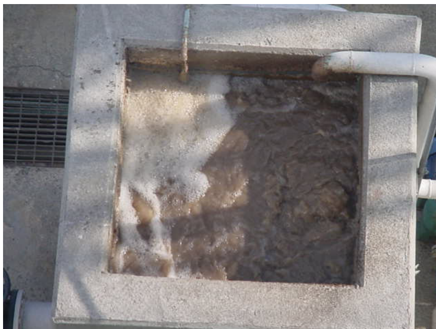
Figura C.17 Tanque de Bombeo en funcionamiento.
