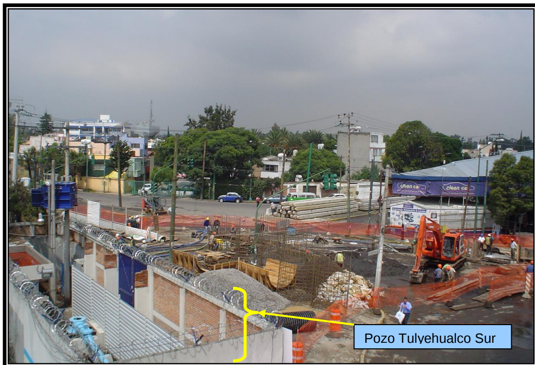
Figura IV.1.1.4.- Reacomodo del muro perimetral del Pozo No. 4 de la DGCOH.
