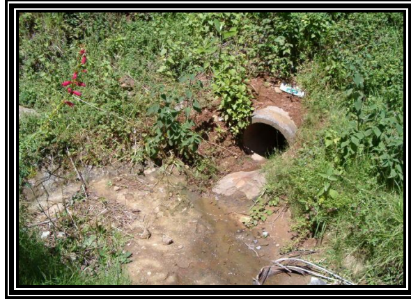
Figura 2.27 descargas de aguas residuales y efluentes
