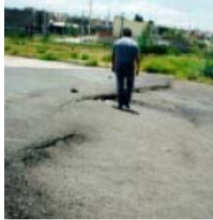
Figura 3.2.1.6. Hundimiento local y agrietamiento del subsuelo.
