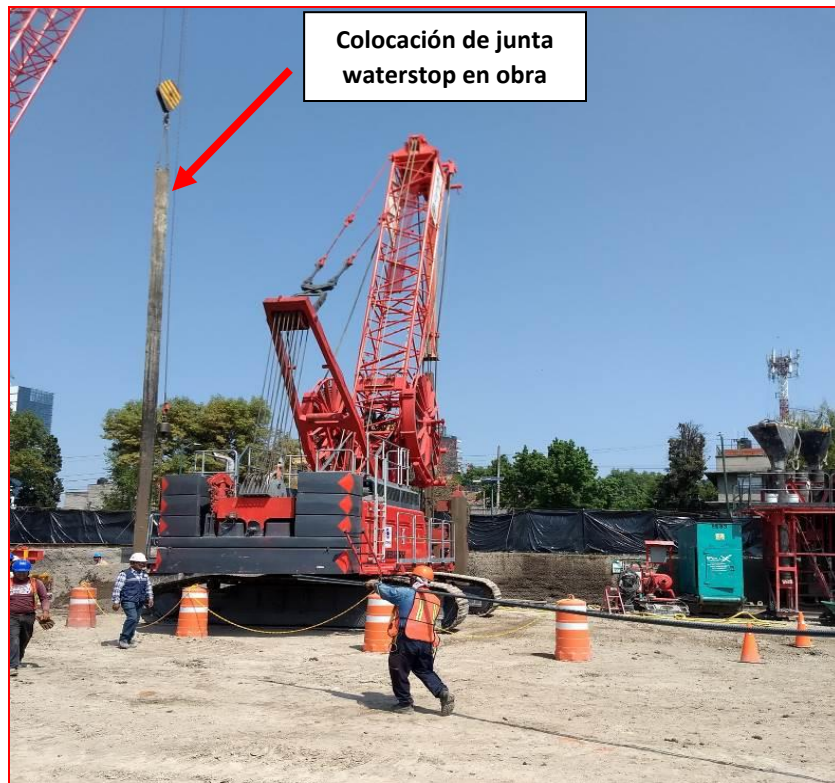
Figura 97. Izaje y colocación de junta waterstop dentro de la excavación; proyecto "MARNHOS, Lago Filt 7". (CIMESA 2018).
