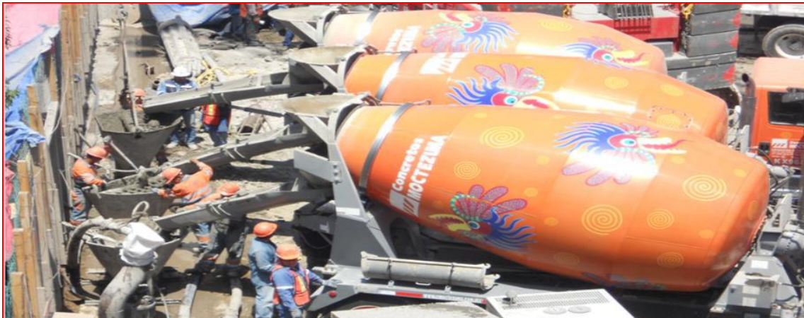
Figura 122. Colado de panel de muro Milán; Autor: Ing. Francisco Israel Callejas Quezada. (CIMESA 2011).
