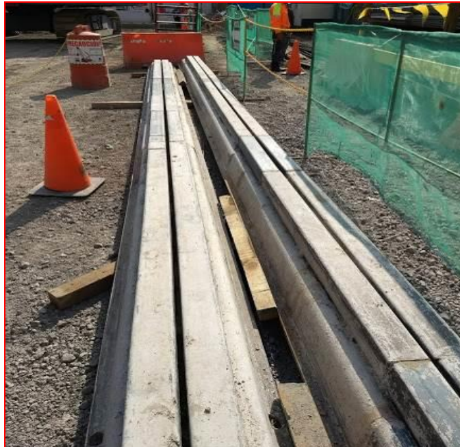
Figura 96. Perfiles de acero para junta, previo a su colocación en la lumbrera; proyecto "MARNHOS, Lago Filt 7". (CIMESA 2018).
