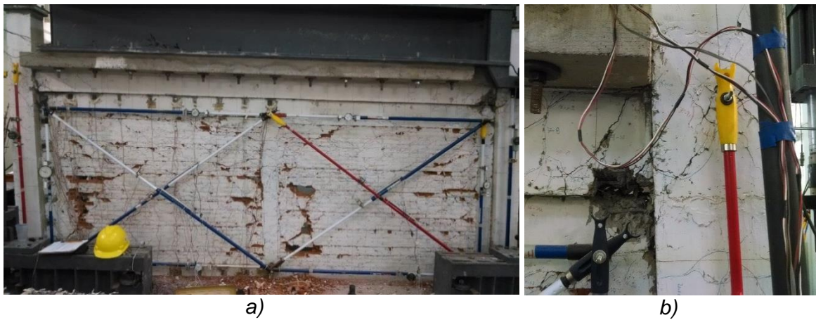
Figura 4.4. Patrón de agrietamiento final del espécimen MD3NRH. a) Agrietamiento en el muro, b) falla en la conexión viga-columna
