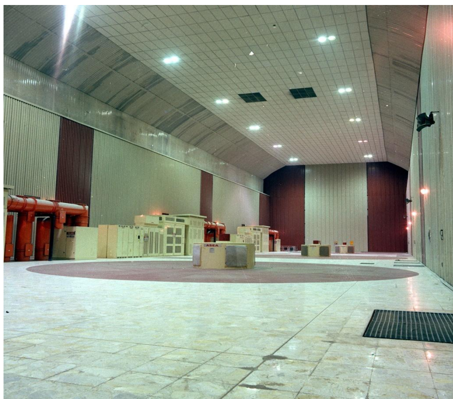
IMAGEN No.18.- Casa de Máquinas Central Hidroeléctrica Chicoasén.
