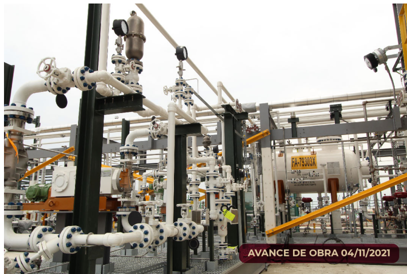
Figura 1.1: Red de tubería en Refinería de Dos Bocas. Fuente: Tomado de Secretaría de Energía (2026).
